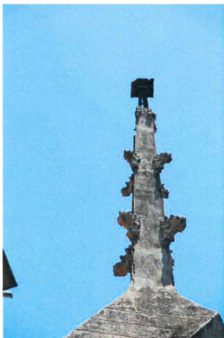
Pináculo com a argamassa armada degradada.
