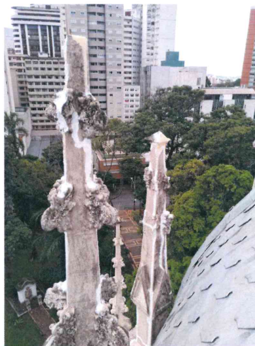
Pináculos de argamassa armada trincados.
