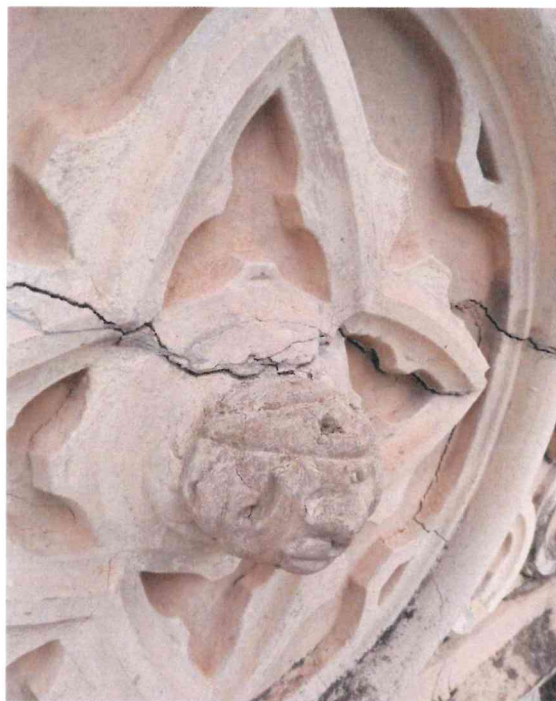
Trinca horizontal no tímpano de um gablete da lanterna da torre do cruzeiro.
