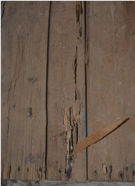
Foto 49: Verso do retábulo evidenciando galerias de insetos xilófagos
