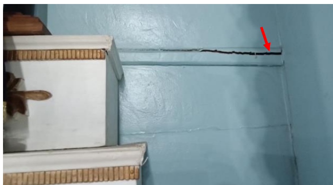
Figura 48: Rachadura em friso do fundo do camarim.
