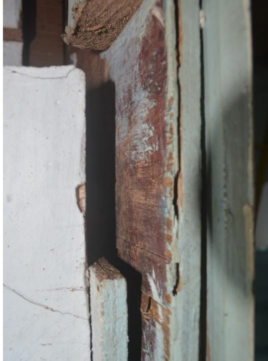
Foto 50: Verso do retábulo evidenciando galerias de insetos xilófagos
