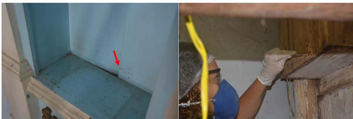
Figuras 46 e 47: Nicho inferior lateral com afastamento da tábua e no verso infestação por xilófagos.
