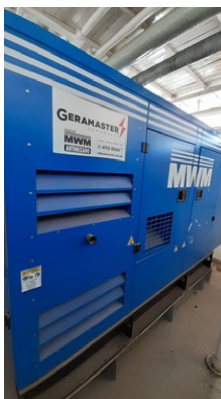
Imagem 02 - Gerador instalado no interior da embarcação - convés de máquinas Fonte: Acervo do IEPHA/MG - 30/07/2022
