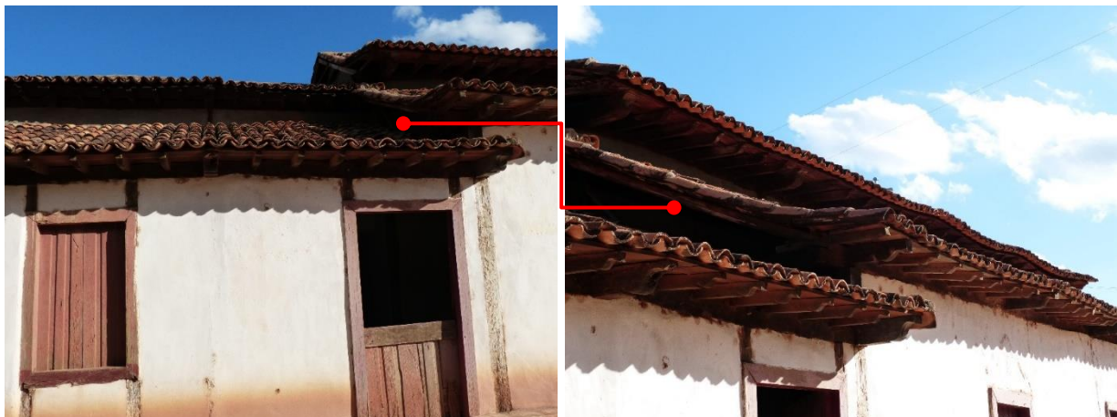
Fig. 16 – Detalhe da cobertura – Espaço entre os telhados sem a execução de empena.
