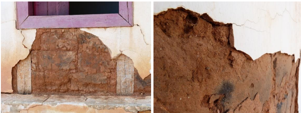
Fig. 55 – Descolamento causado pela incompatibilidade de materiais usados no reboco original e nas intervenções.
