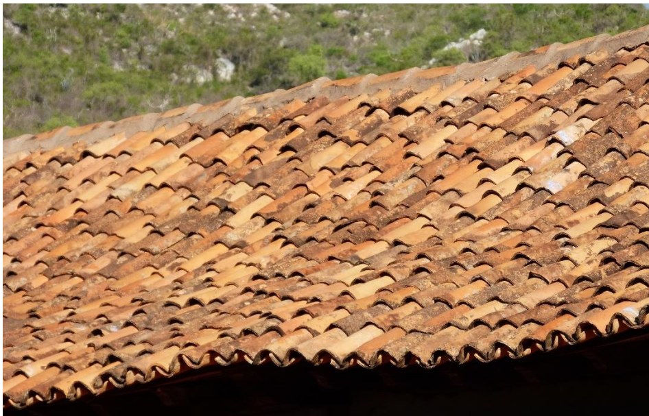
Fig. 11 – Detalhe da cobertura – Afundamento nos planos de cobertura.
