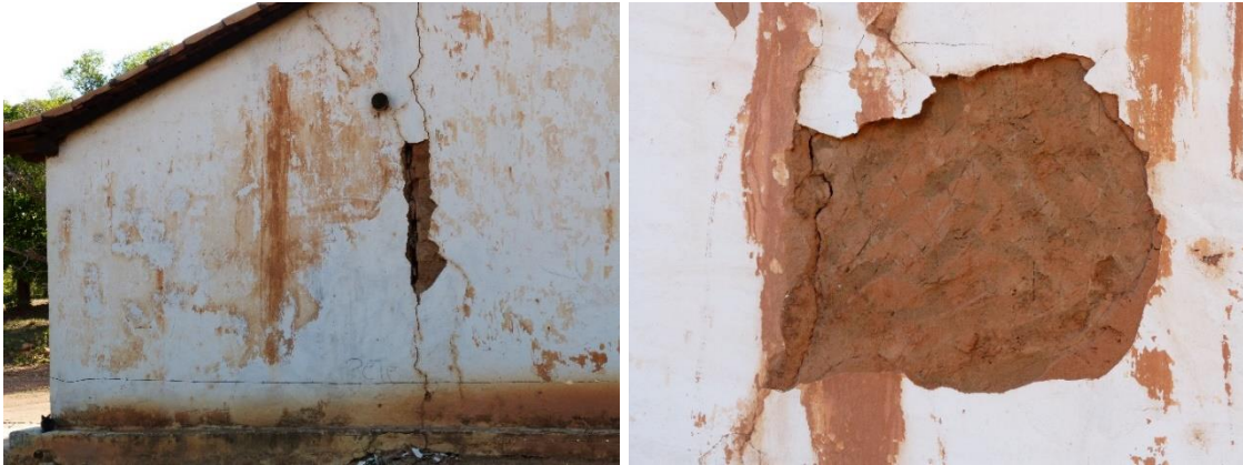
Fig. 54 – Descolamento causado pela incompatibilidade de materiais usados no reboco original e nas intervenções.
