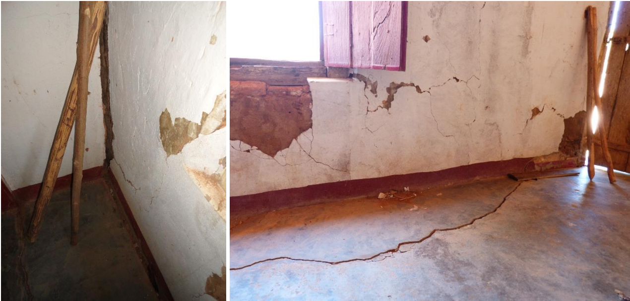
Fig. 48 – Sacristia do Lado Direito – Rachaduras e abatimento no piso.
