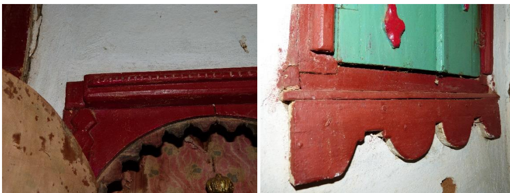
Fig. 161 – Detalhe do Nicho da Capela do Santíssimo (lado direito) – Partes deterioradas.
