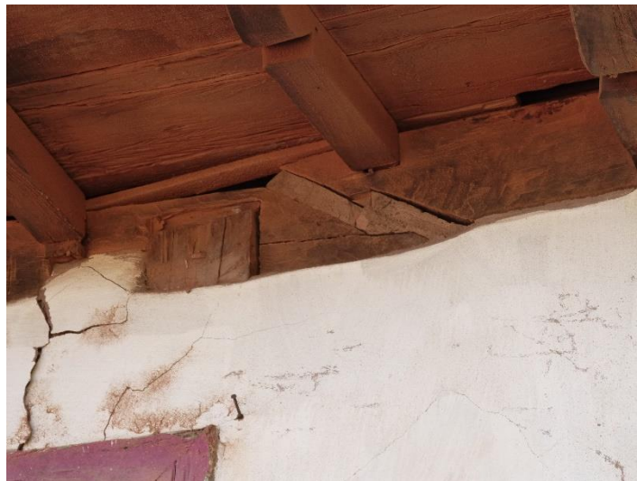
Fig. 29 – Desarranjo das peças da estrutura – folga preenchida com argamassa.
