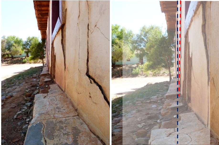
Fig. 52 – Desaprumo das paredes provocado pela movimentação da estrutura – fachada lateral direita.
