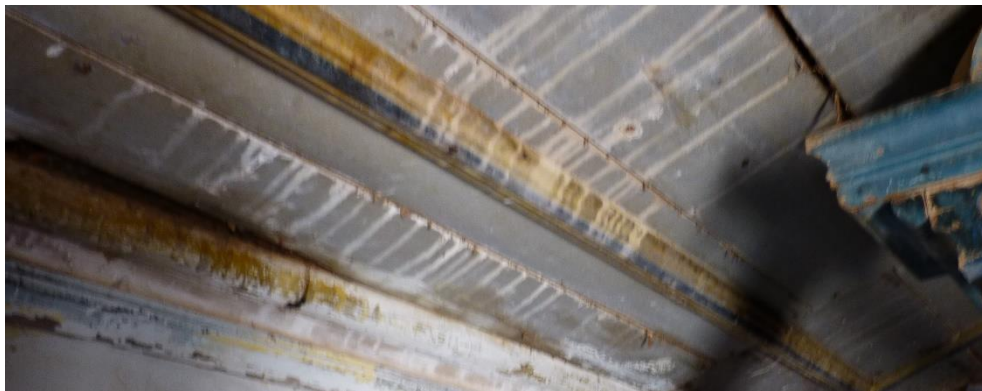
Fig. 142 – Detalhe do forro da Capela do Santíssimo Sacramento – Escorrimentos.
