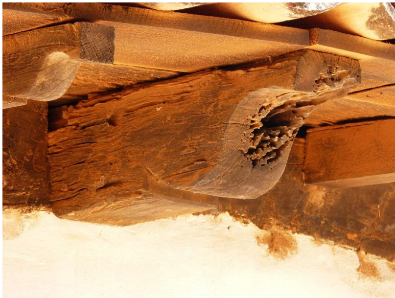
Fig. 23 – Detalhe da cobertura – Peça de madeira atacada por cupins de solo.
