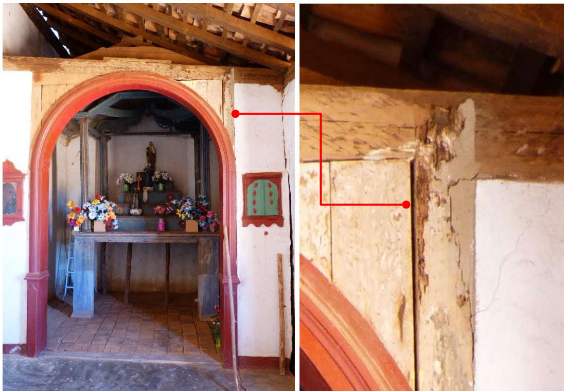
Fig. 126 – Detalhe do apodrecimento no esteio que sustenta o arco.
