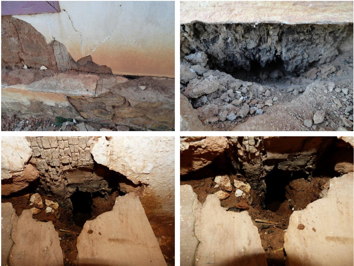
Fig. 35 – Deterioração das bases dos esteios por apodrecimento.
