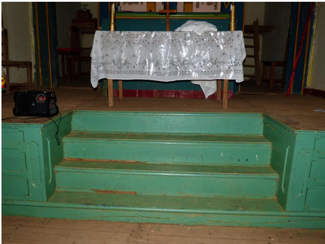
Fig. 87 – Detalhe do estado de conservação da escada – acesso ao púlpito (parte posterior).
