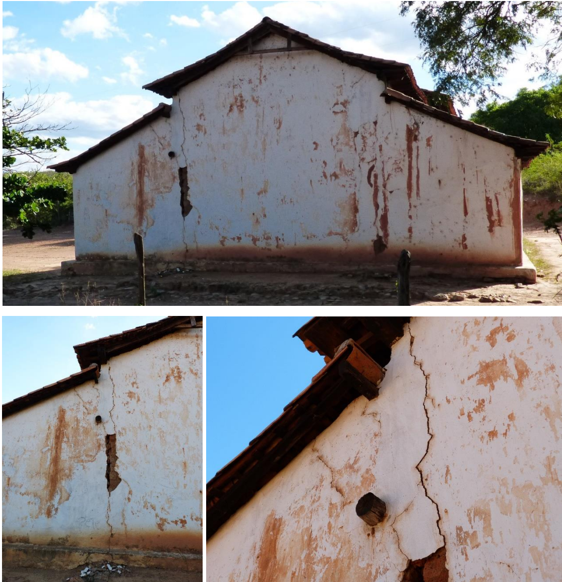
Fig. 31 – Rachaduras provocadas pela deterioração das bases dos esteios – fachada posterior.
