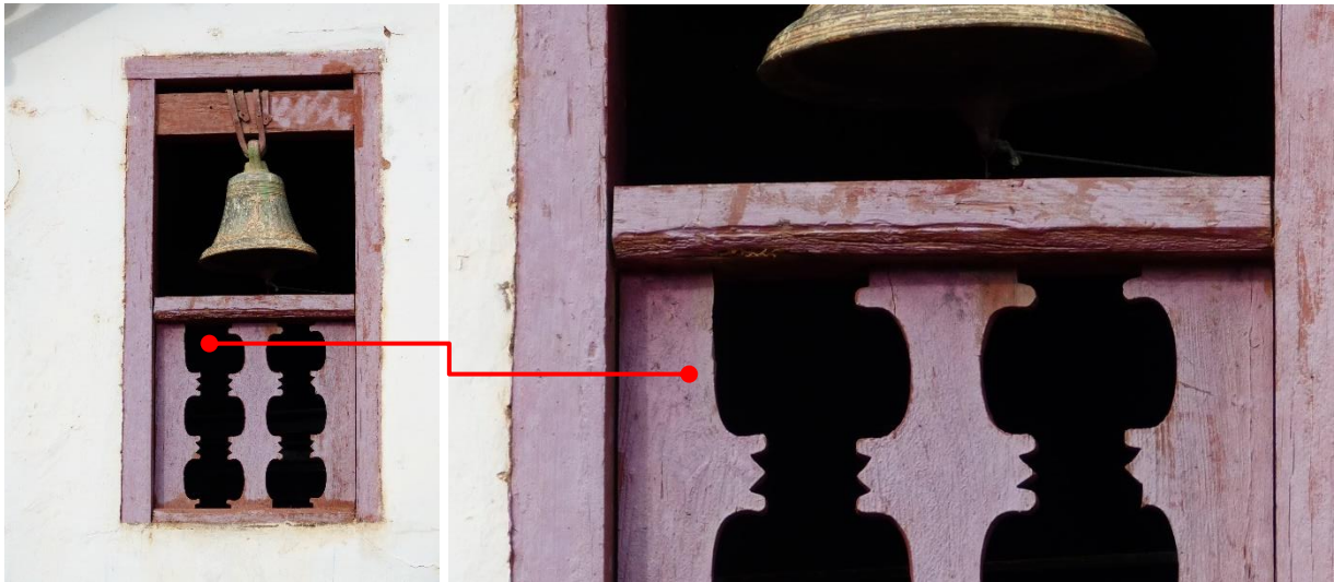
Fig. 103 – Detalhe do estado de conservação das janelas do coro – Tábuas com perdas pontuais.
