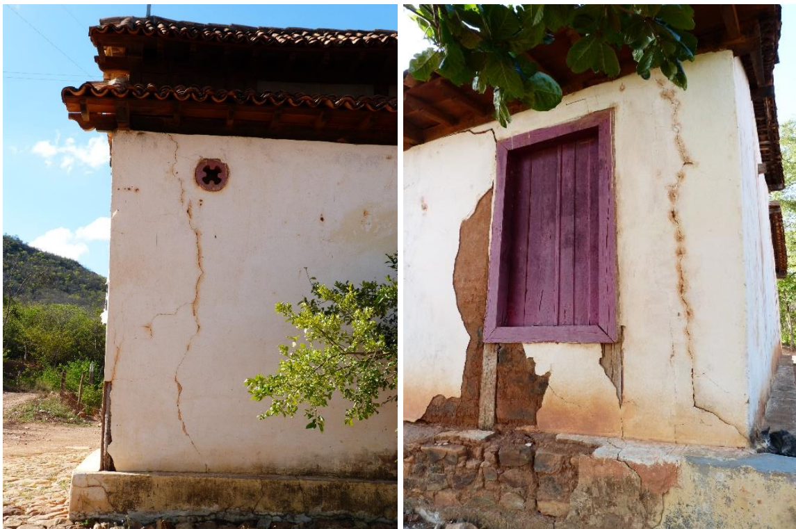
Fig. 51 – Rachaduras nas paredes provocadas pela movimentação da estrutura.
