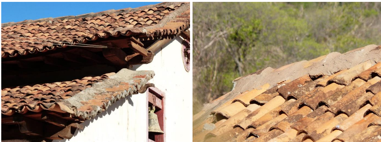
Fig. 20 – Detalhe da cobertura – Embocamento das telhas realizados incorretamente.
