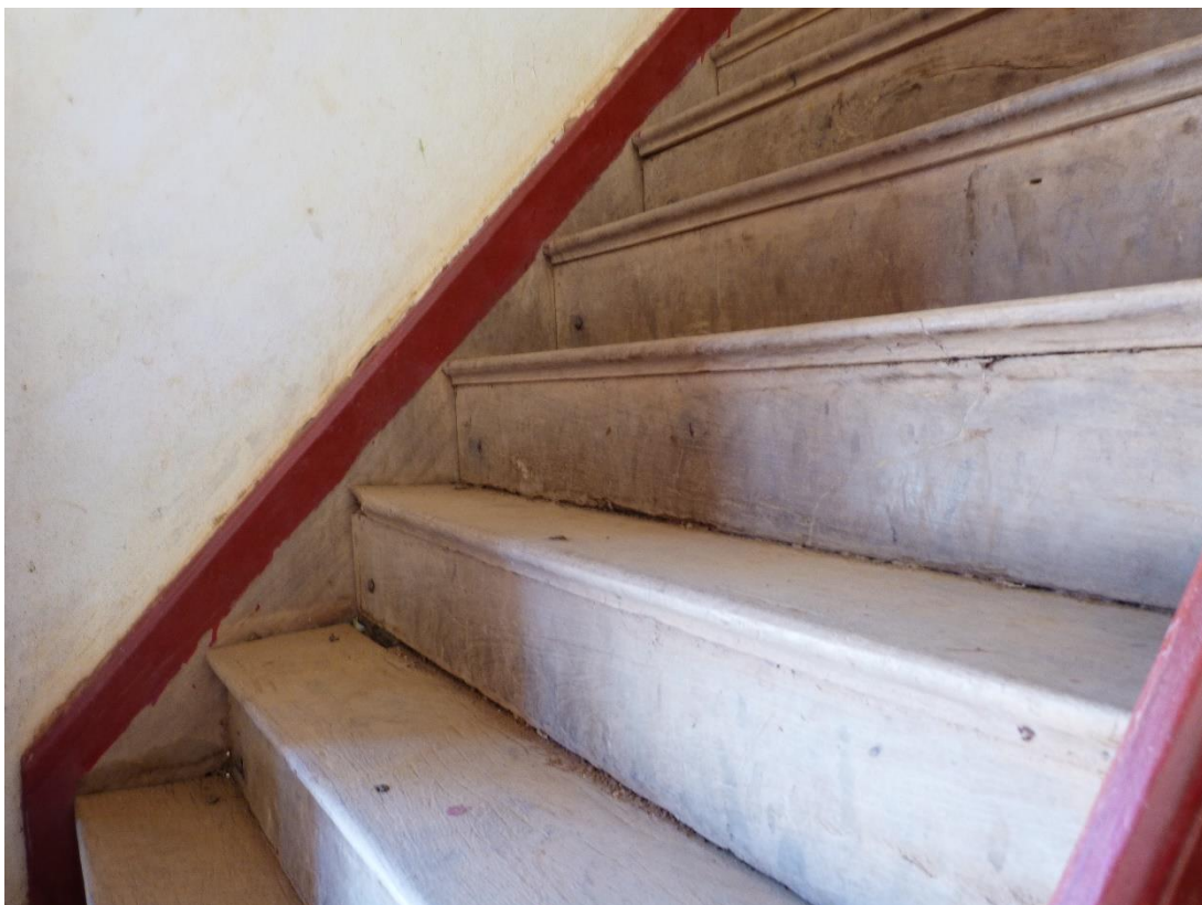
Fig. 82 – Detalhe do estado de conservação da escada – acesso ao coro.
