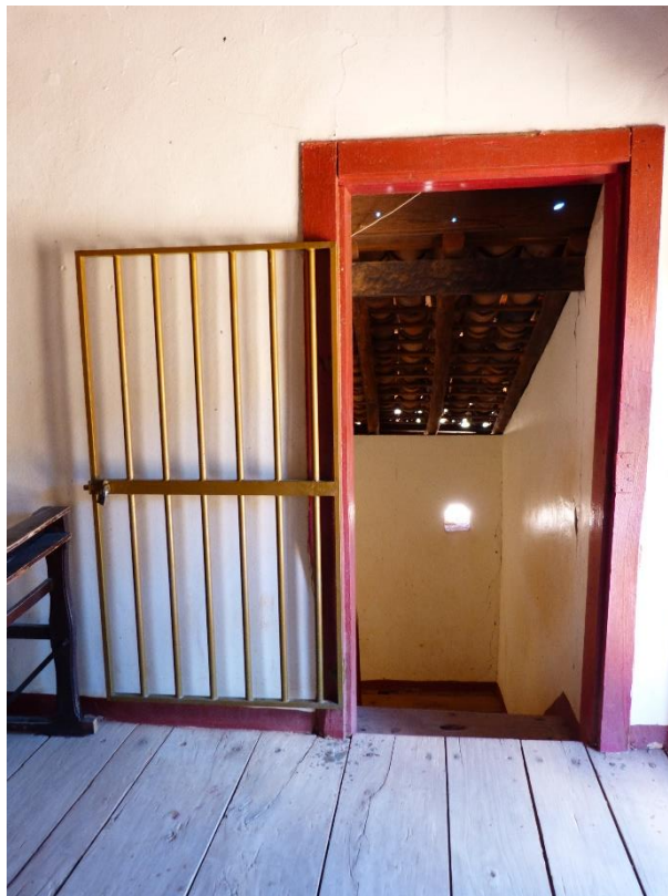
Fig. 110 – Intervenção inadequada – Instalação de grade no lugar da porta original.
