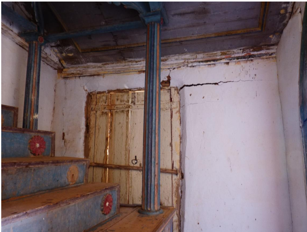
Fig. 49 – Capela do Santíssimo Sacramento – Rachaduras nas paredes.
