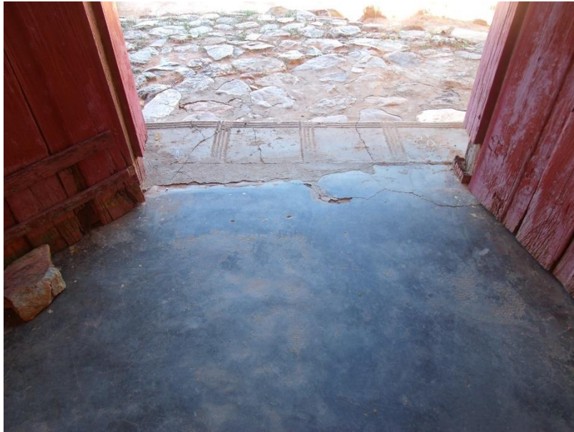
Fig. 78 – Detalhes do estado de conservação do piso em cimento queimado.
