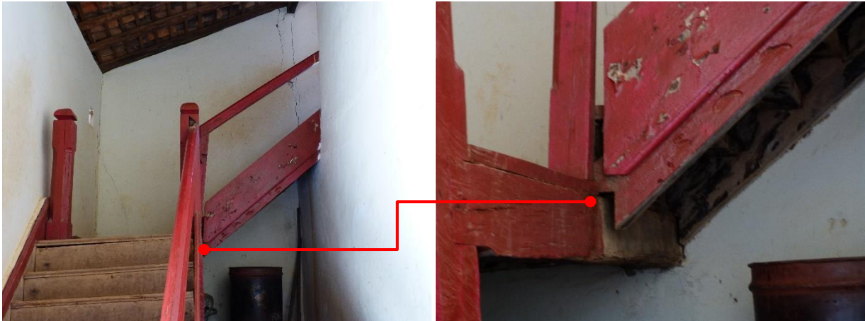
Fig. 83 – Detalhe do estado de conservação da escada – acesso ao coro.
