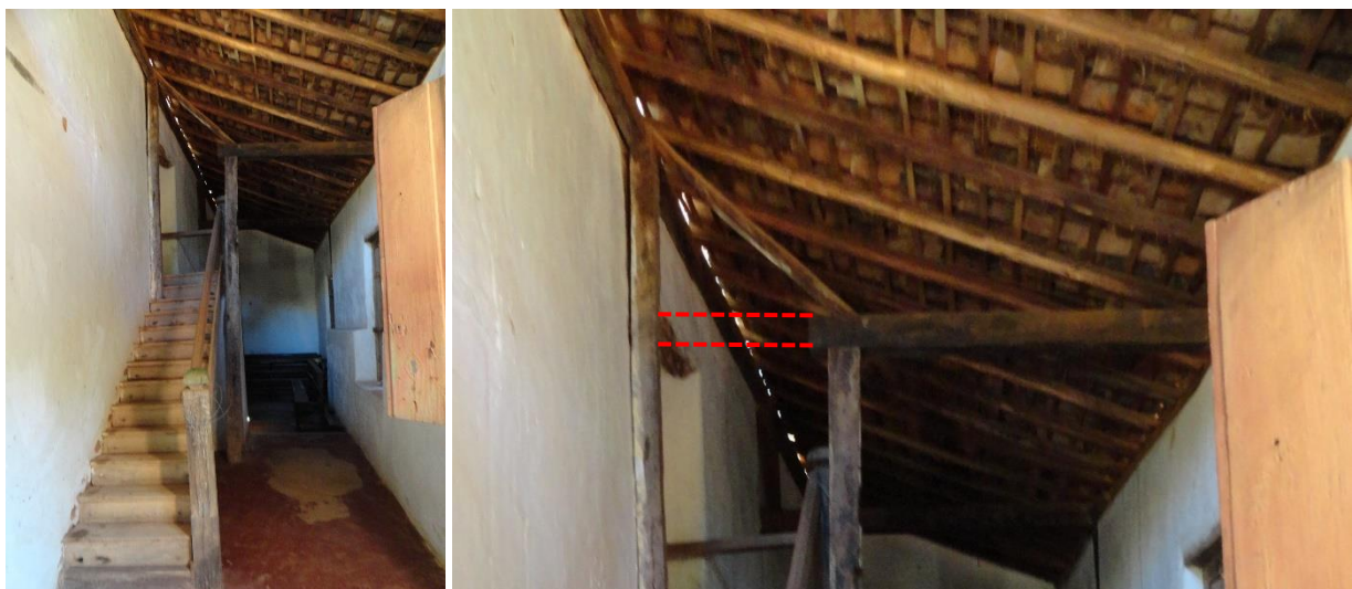
Fig. 42 – Alteração na estrutura de madeira – hall de acesso ao púlpito.
