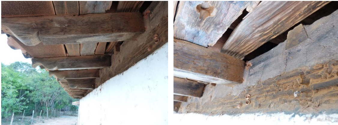
Fig. 14 – Detalhe da cobertura – Desalinhamento dos beirais.
