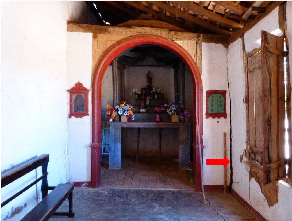
Fig. 125 – Vista geral – Arco Capela Santíssimo (detalhe do local em arruinação).
