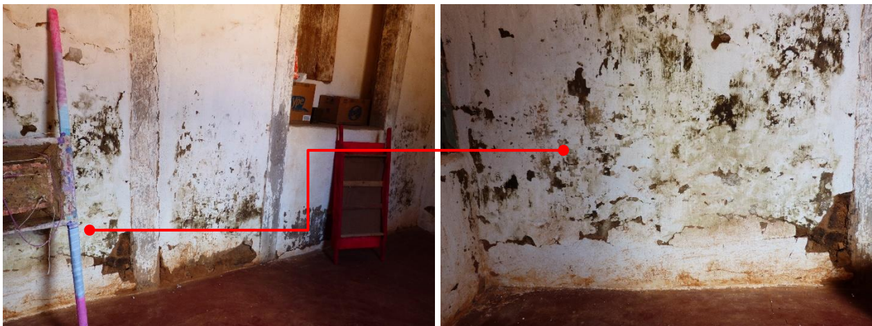
Fig. 63 – Manchas de umidade formadas na parede – hall de acesso ao púlpito.
