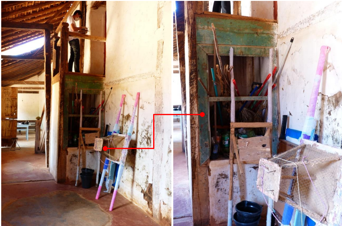
Fig. 86 – Detalhe do estado de conservação da escada – acesso ao púlpito (parte posterior).
