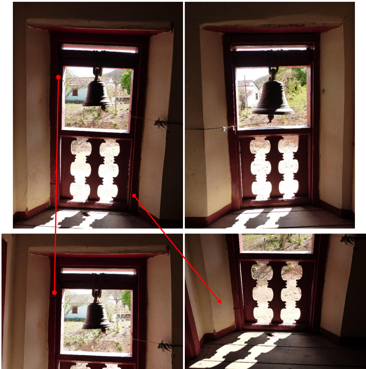
Fig. 102 – Detalhe do estado de conservação – Janelas do coro.
