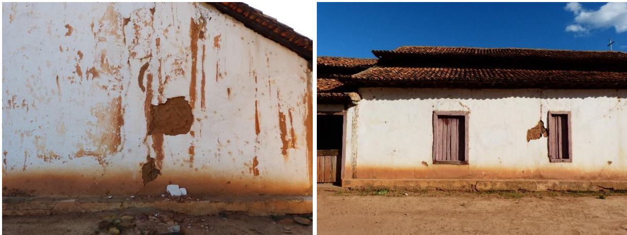
Fig. 62 – Acúmulo de sujeira nas paredes externas.
