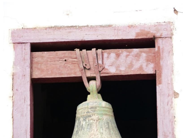
Fig. 104 – Detalhe do estado de conservação – Janelas do coro.
