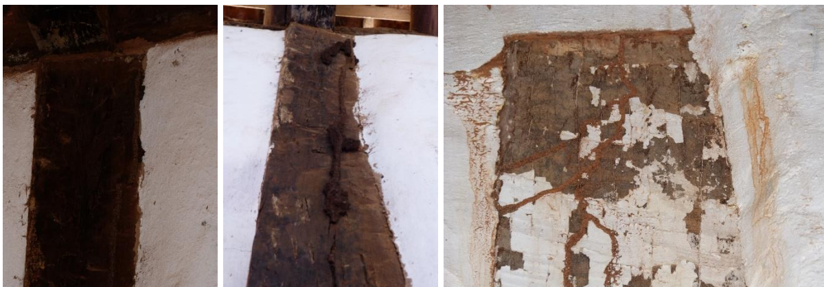
Fig. 38 – Galerias formadas por cupins de solo sobre os esteios.
