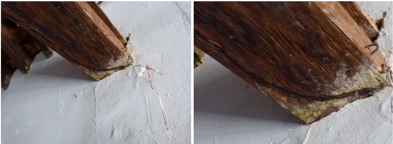
Fig. 22 – Detalhe da cobertura – Galeria produzida por cupins de solo (tirante do telhado na nave).
