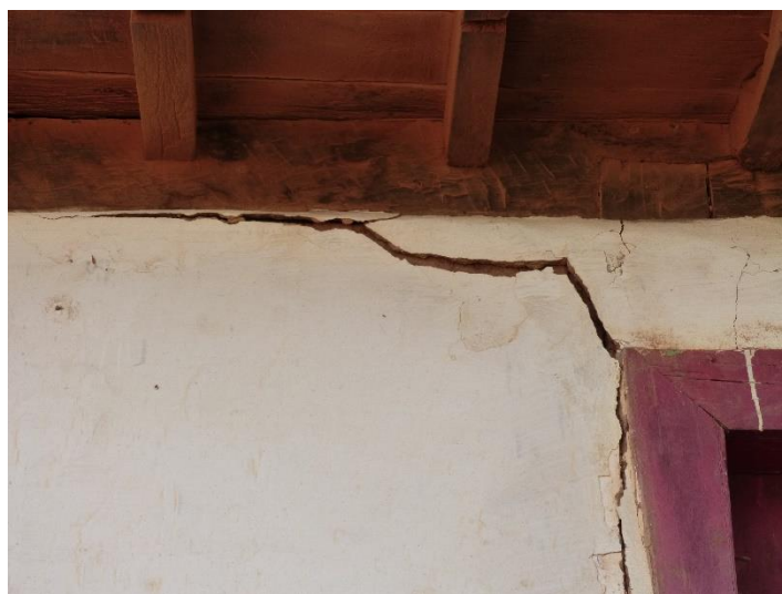
Fig. 30 – Rachaduras provocadas pela deterioração das bases dos esteios.
