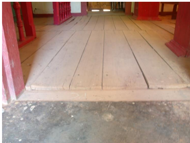
Fig. 70 – Afundamento observado na soleira da Porta PD.
