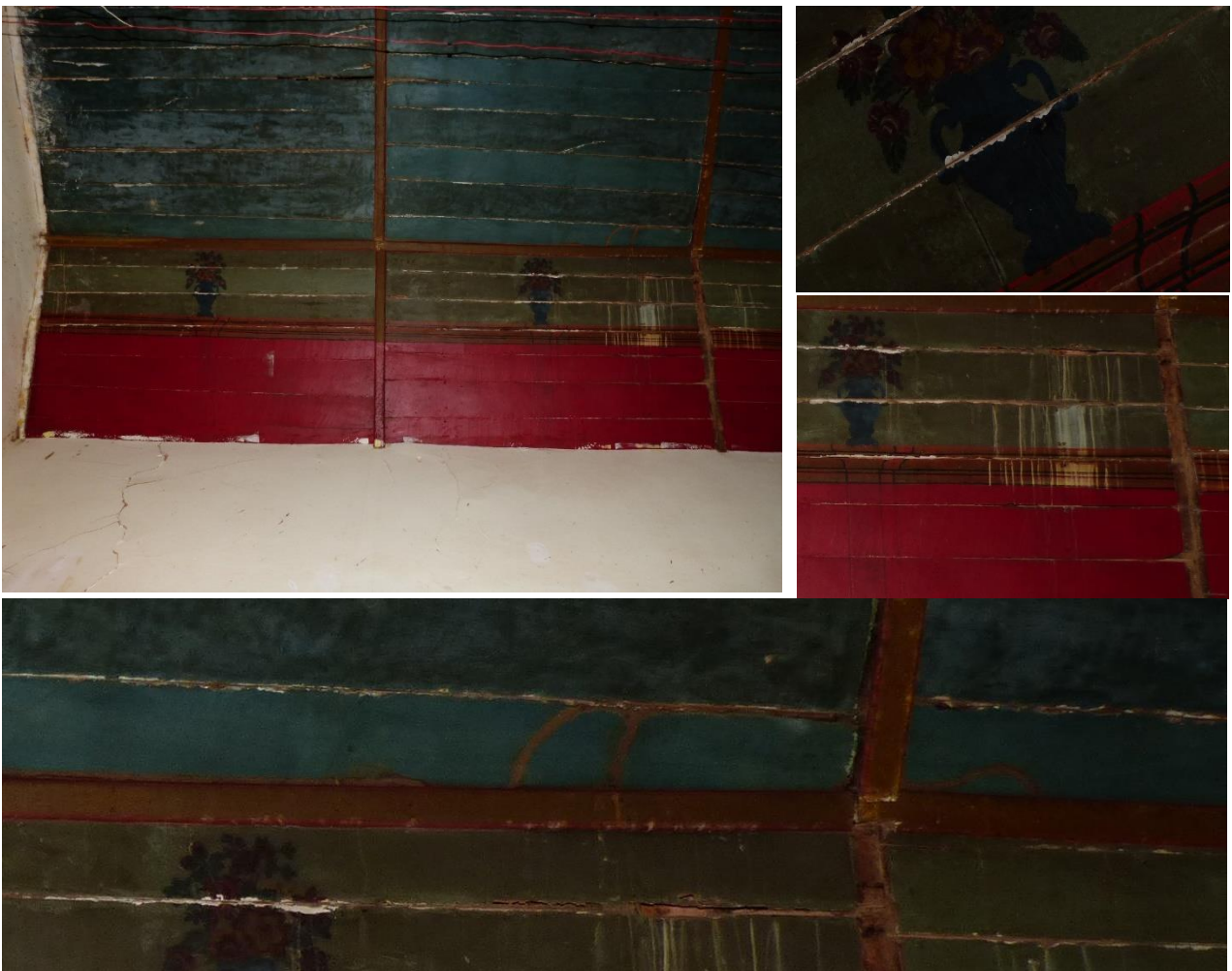
Fig. 138 – Detalhe do forro da capela-mor – Patologias.
