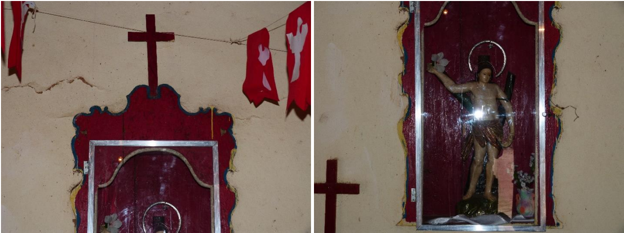
Fig. 169 – Detalhe do Nicho da Nave (lado esquerdo) – Descaracterizações.
