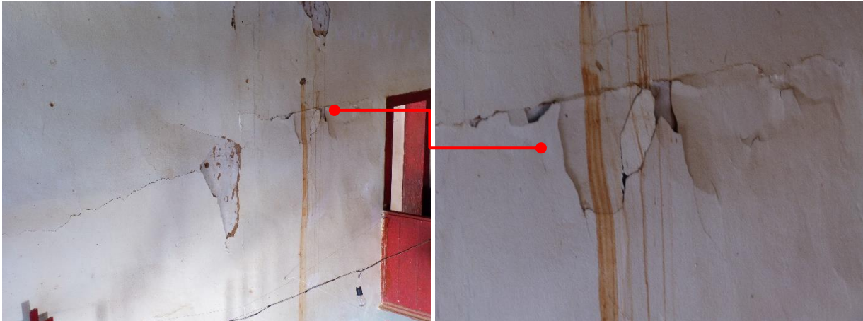
Fig. 57 – Descolamento causado pela incompatibilidade de materiais usados no reboco original e nas intervenções.
