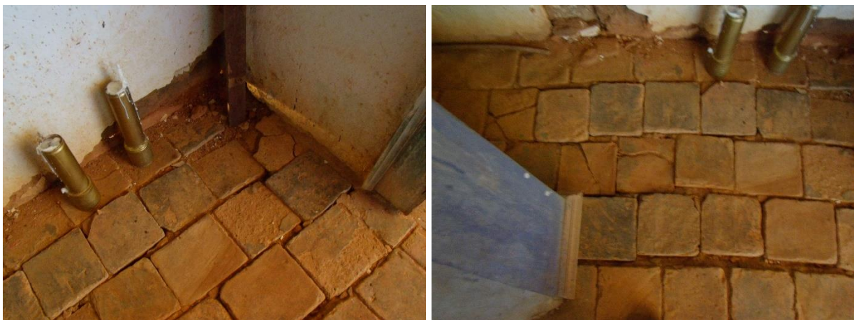
Fig. 75 – Peças fraturadas e desnivelamento do piso de lajotas cerâmicas – Capela do Santíssimo.
