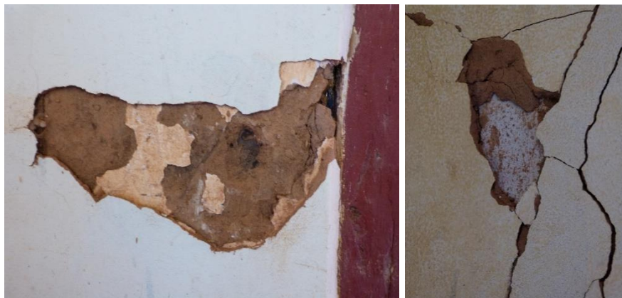
Fig. 56 – Descolamento causado pela incompatibilidade de materiais usados no reboco original e nas intervenções.
