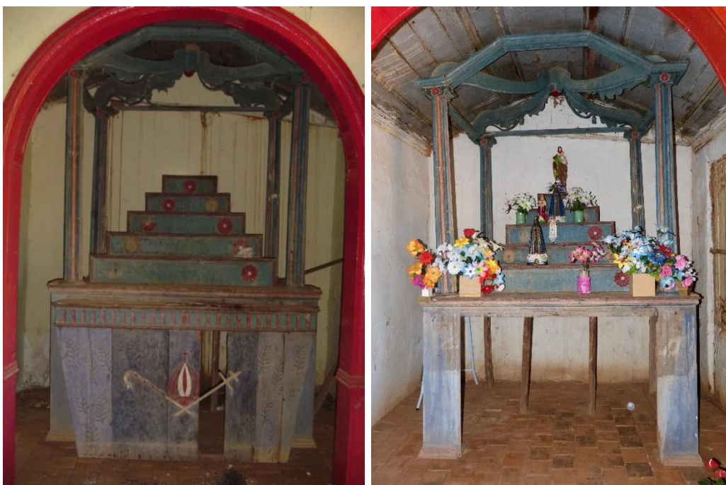
Fig. 156 – Detalhe de retábulo da Capela do Santíssimo – Perda de elementos (foto 1 – retirada do dossiê de tombamento da capela executado em março de 2002).
