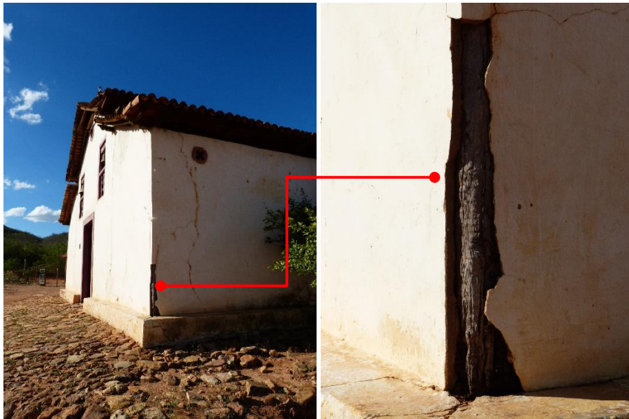
Fig. 60 – Perda pontual do reboco expondo as estruturas – paredes externas.
