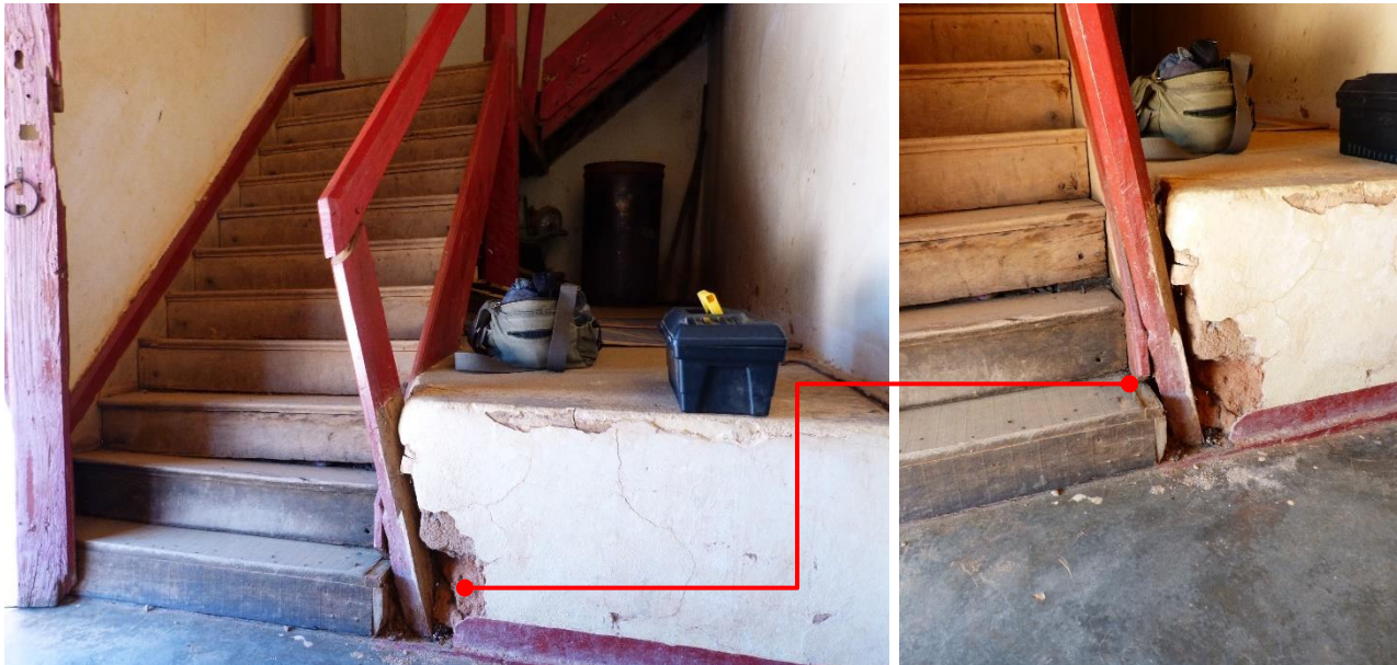
Fig. 81 – Detalhe do estado de conservação da escada – acesso ao coro.
