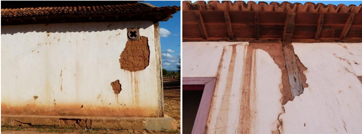
Fig. 59 – Carreamento de material favorecido pelo descolamento do reboco – paredes externas.
