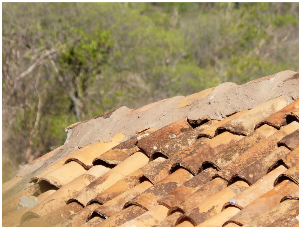
Fig. 09 – Detalhe da cobertura – Telhas deslocadas ou quebradas.
