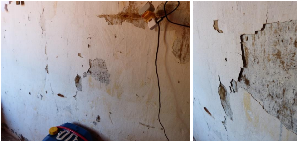
Fig. 64 – Pintura a base de cal com descamação superficial.
