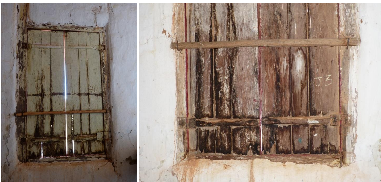
Fig. 97 – Detalhe do estado de conservação – Janelas J3 e J4.
