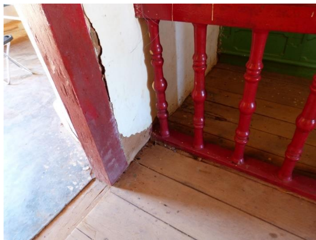
Fig. 71 – Afundamento observado na soleira da Porta PD.
