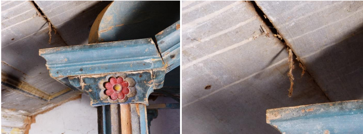
Fig. 141 – Detalhe do forro da Capela do Santíssimo Sacramento – Matéria orgânica depositada sobre o forro.
