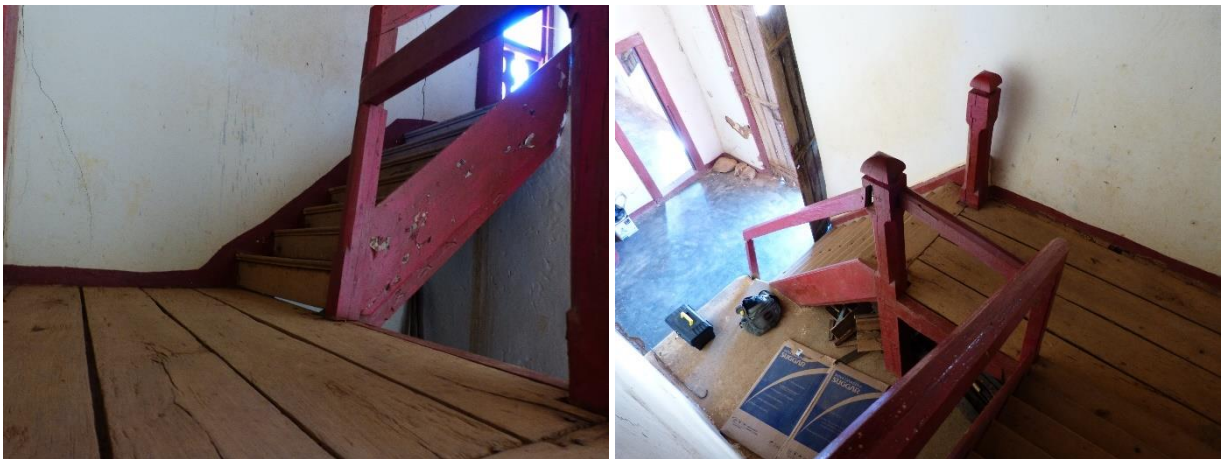
Fig. 84 – Detalhe do estado de conservação da escada – acesso ao coro.
