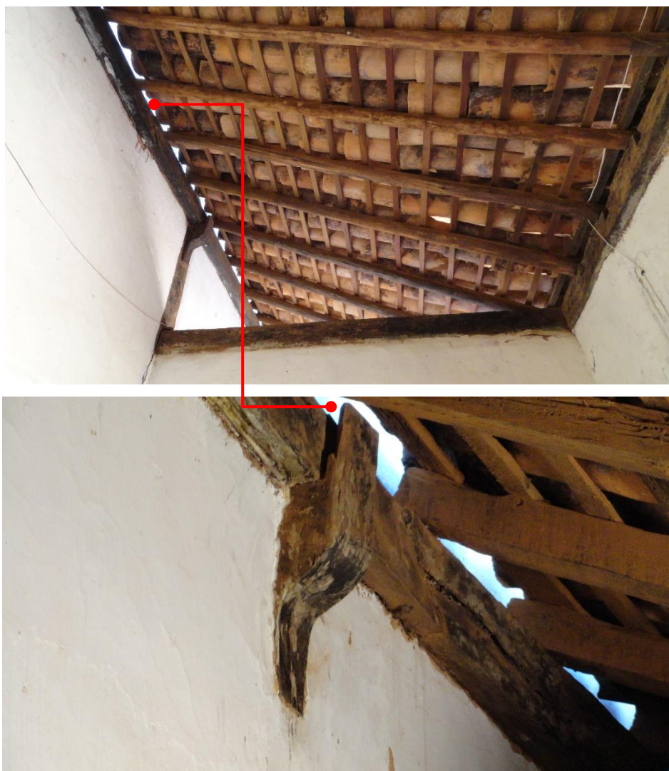
Fig. 18 – Detalhe da cobertura – Falta de rufo para acabamento do telhado.
