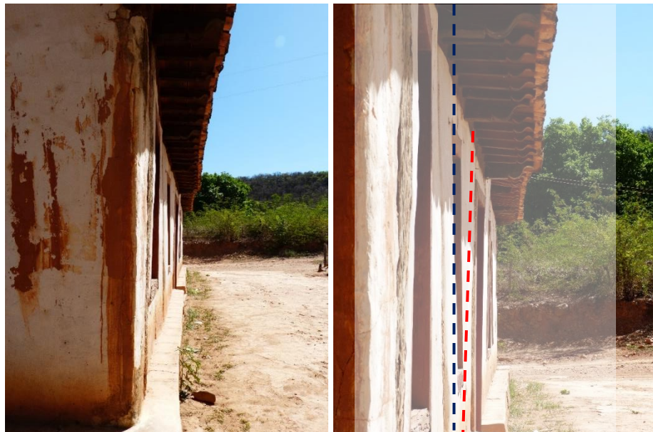
Fig. 53 – Desaprumo das paredes provocado pela movimentação da estrutura – fachada lateral direita.
