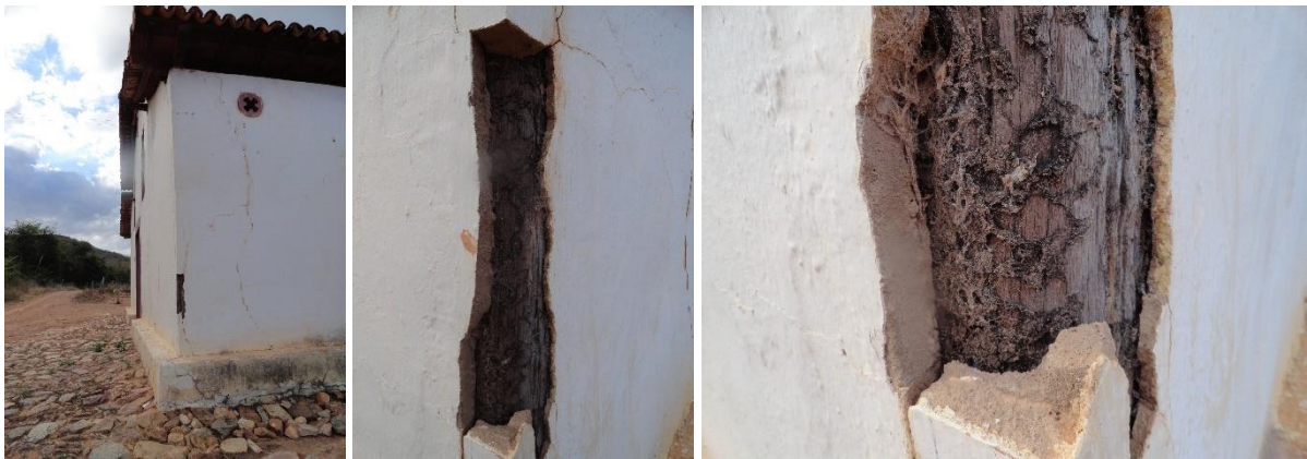
Fig. 39 – Infestação de cupins no cunhal direito da fachada frontal.
