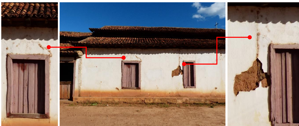
Fig. 32 – Rachaduras provocadas pela deterioração das bases dos esteios – fachada lateral esquerda.
