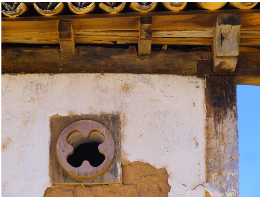
Fig. 115 – Detalhe do estado de conservação – Óculo da fachada lateral esquerda.
