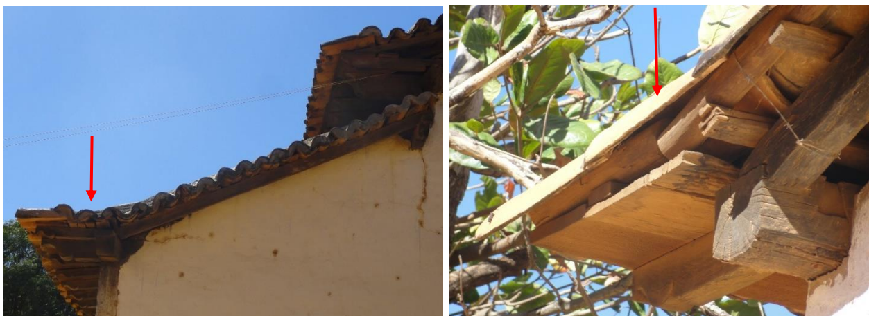
Fig. 17 – Detalhe da cobertura – Execução incorreta do galbo do contrafeito.
