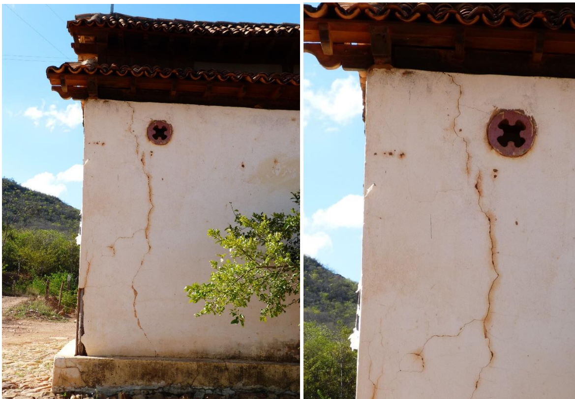
Fig. 27 – Rachaduras provocadas pela deterioração das bases dos esteios.
