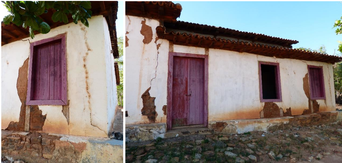
Fig. 28 – Rachaduras provocadas pela deterioração das bases dos esteios.
