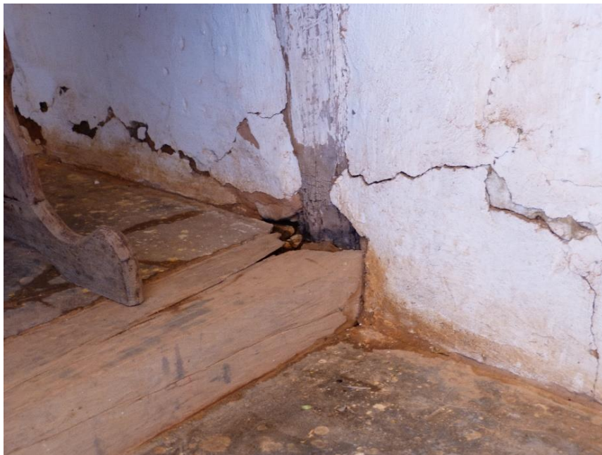
Fig. 34 – Deterioração das bases dos esteios por apodrecimento.
