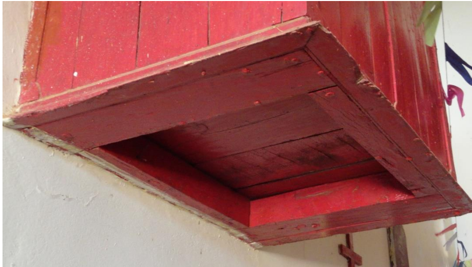
Fig. 113 – Detalhe do estado de conservação – Perdas pontuais na base do púlpito.
