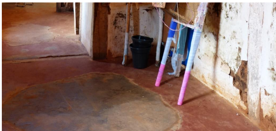
Fig. 77 – Detalhes do estado de conservação do piso em cimento queimado.
