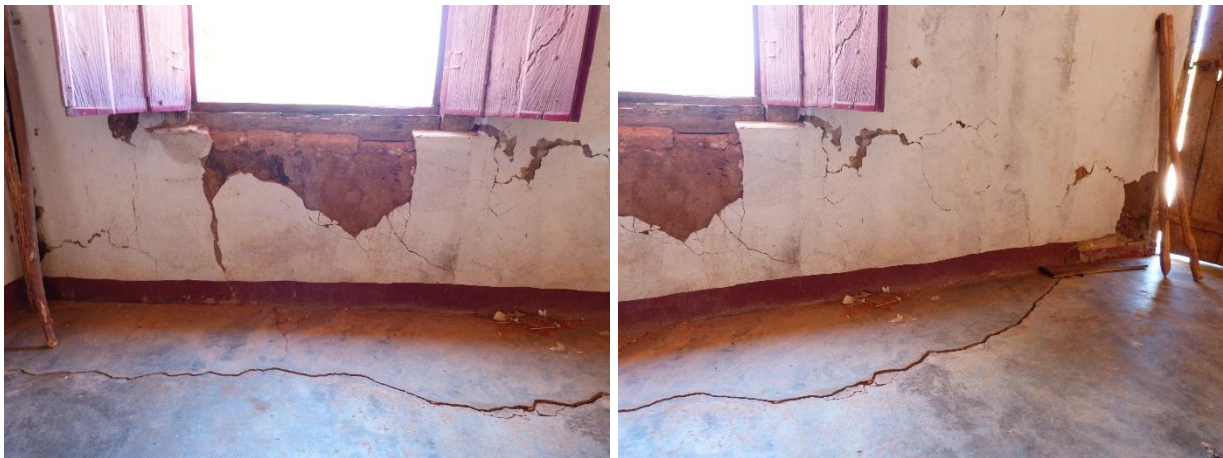
Fig. 76 – Detalhes do estado de conservação do piso em cimento queimado.
