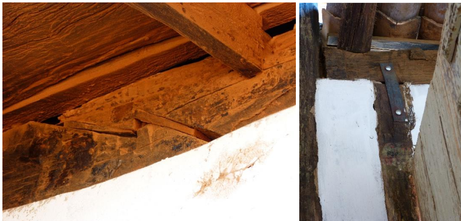
Fig. 45 – Enxerto de cunhas de madeira em folgas dos encaixes e fixação da estrutura com chapa metálica.
