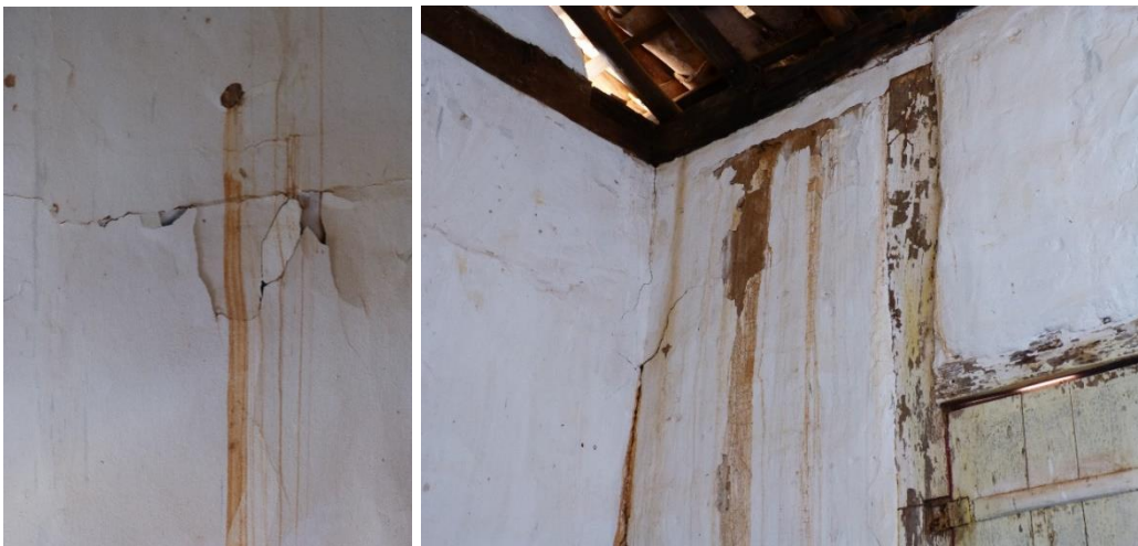
Fig. 58 – Carreamento de material favorecido pelo descolamento do reboco – paredes internas.
