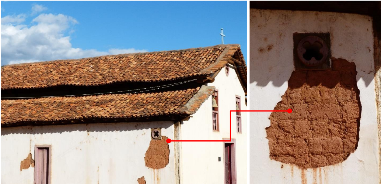
Fig. 114 – Detalhe do estado de conservação – Óculo da fachada lateral esquerda.
