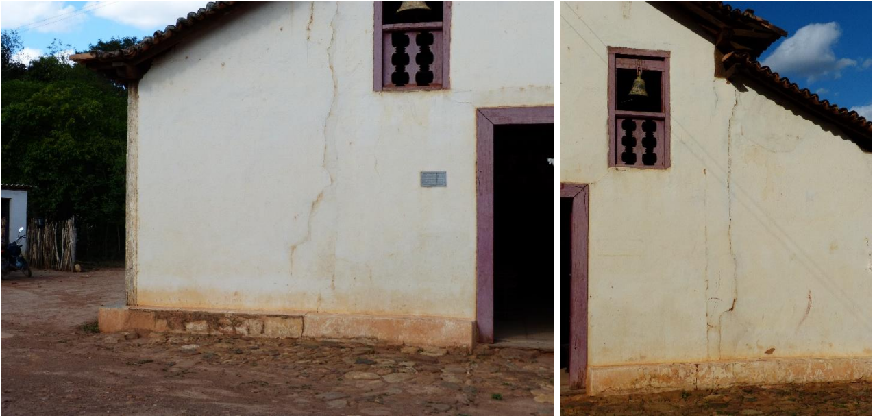
Fig. 50 – Rachaduras nas paredes provocadas pela movimentação da estrutura.
