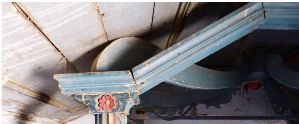
Fig. 143 – Detalhe do forro da Capela do Santíssimo Sacramento – Deteriorações superficiais.
