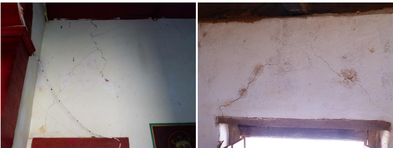
Fig. 37 – Rachaduras formadas acima da porta PD e da janela J9.
