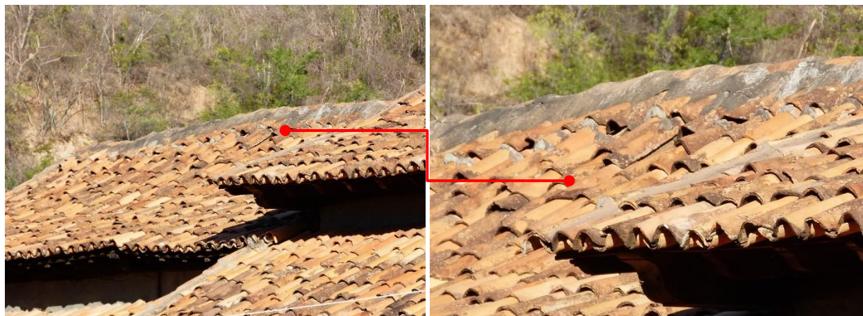
Fig. 08 – Detalhe da cobertura – Telhas deslocadas ou quebradas.
