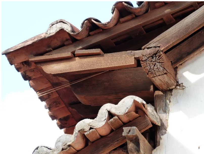
Fig. 25 – Detalhe da cobertura – Peças de madeira deterioradas pela exposição às intempéries.
