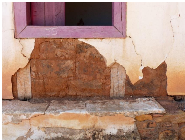
Fig. 101 – Detalhe do estado de conservação – Esteios das janelas comprometidos.
