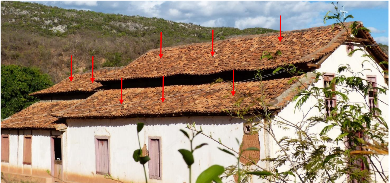
Fig. 10 – Detalhe da cobertura – Afundamento nos planos de cobertura.
