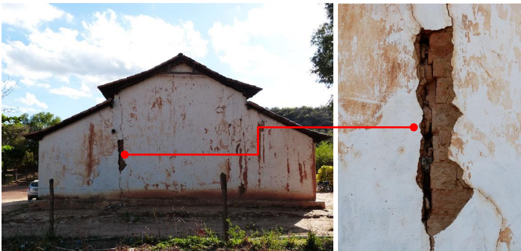
Fig. 61 – Perda pontual do reboco expondo o adobe – paredes externas.
