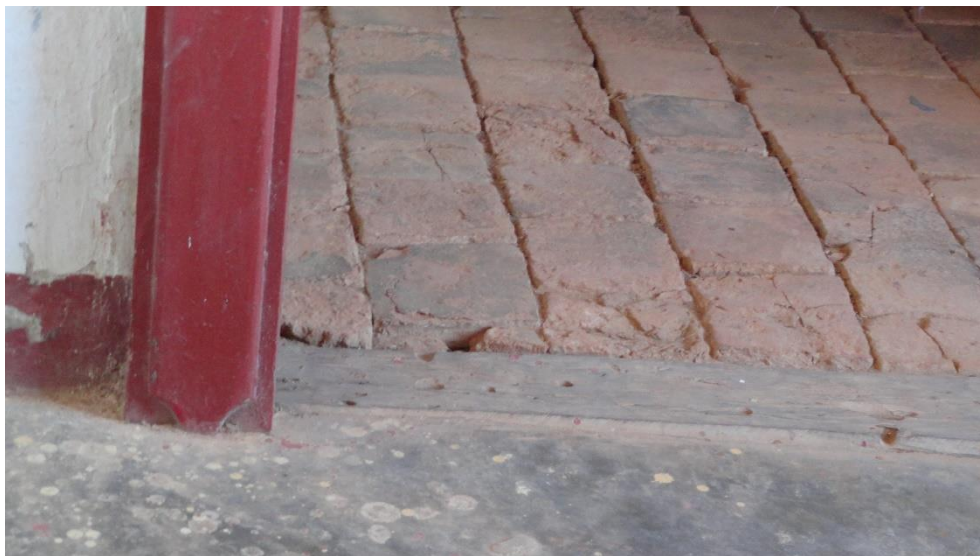
Fig. 74 – Desgaste superficial do piso de lajotas cerâmicas – Capela do Santíssimo.
