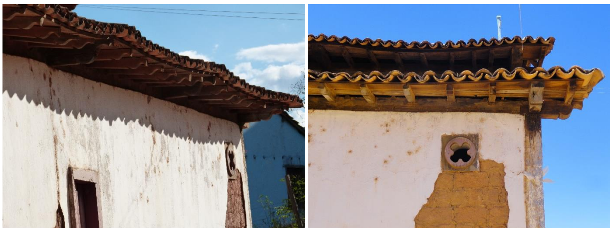
Fig. 13 – Detalhe da cobertura – Desalinhamento dos beirais.
