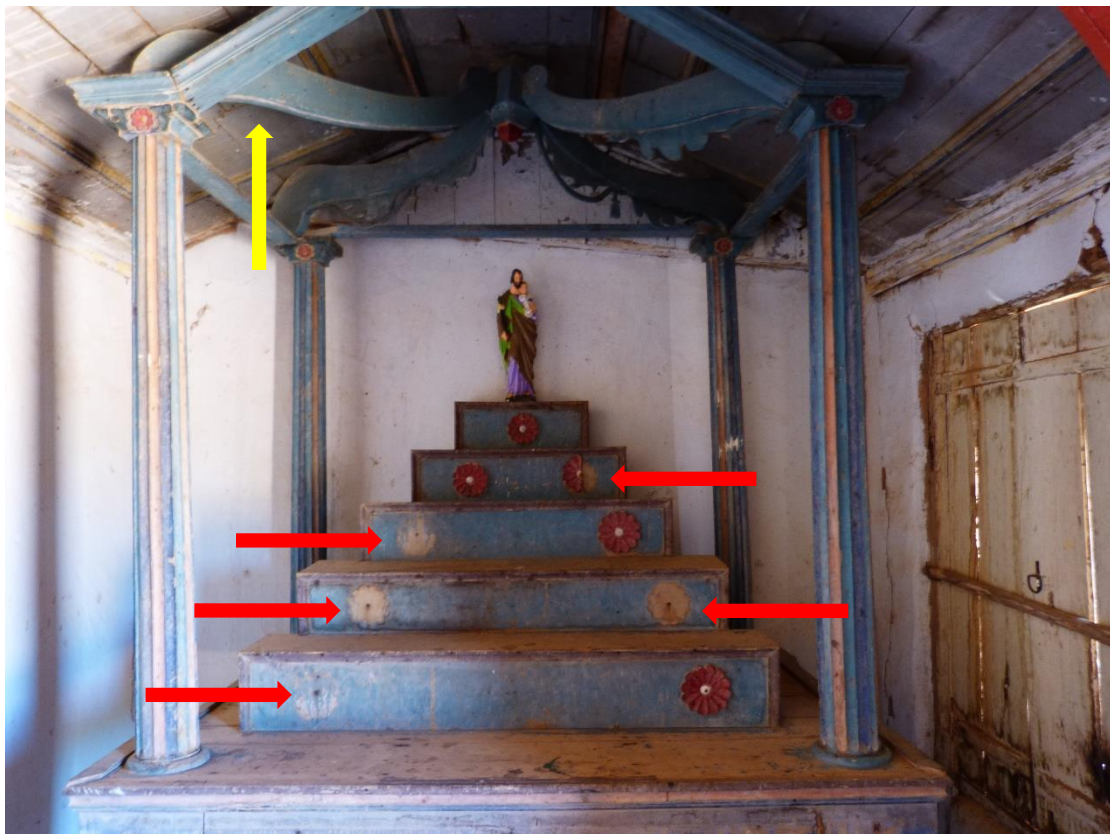
Fig. 155 – Detalhe de retábulo da Capela do Santíssimo – Perda de elementos.
