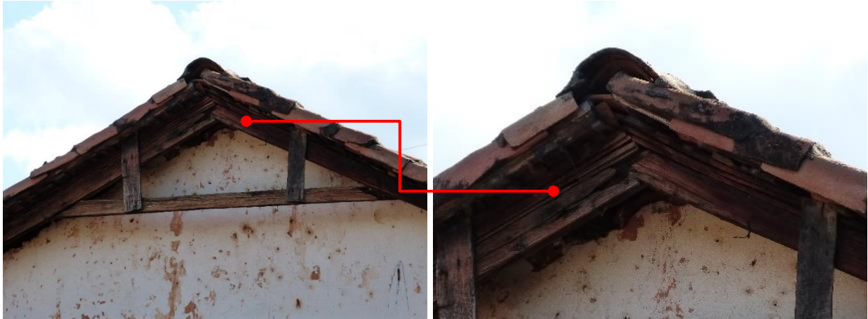
Fig. 24 – Detalhe da cobertura – Peças de madeira com apodrecimentos.
