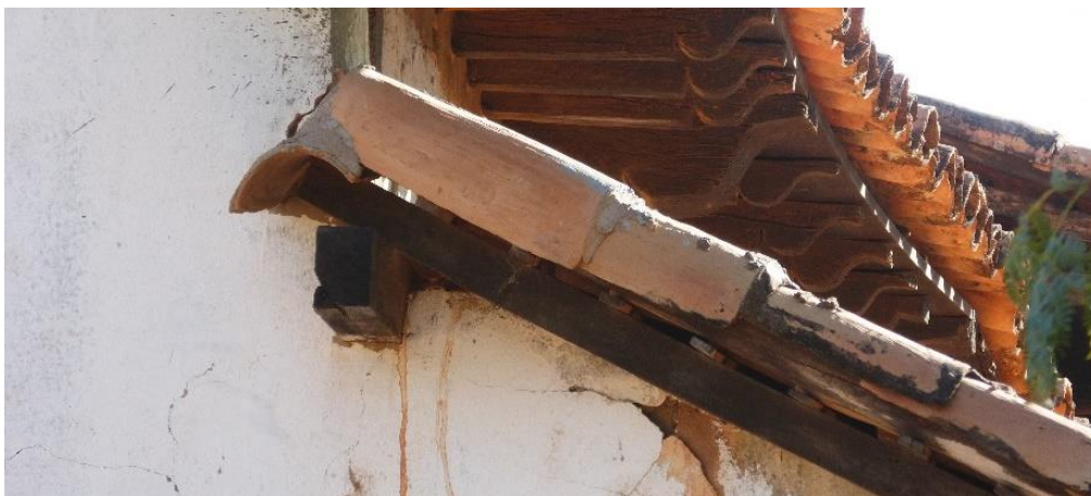
Fig. 21 – Detalhe da cobertura – Embocamento das telhas realizados incorretamente.
