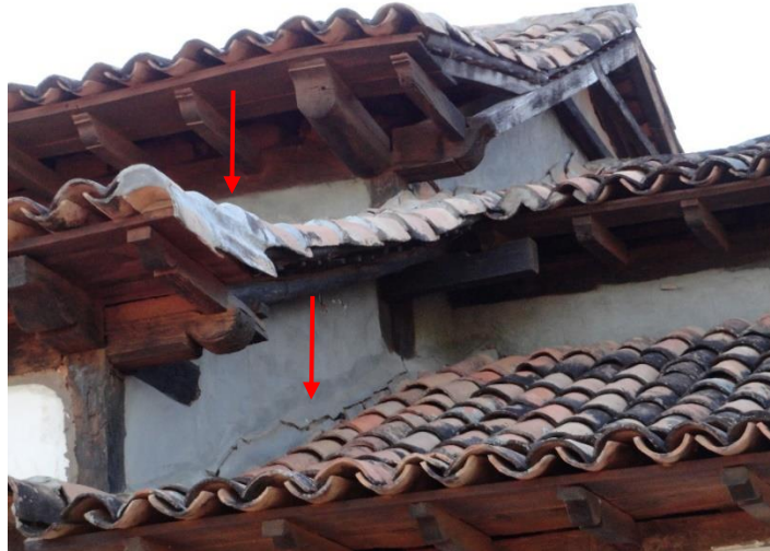
Fig. 19 – Detalhe da cobertura – Embocamento das telhas realizados incorretamente.
