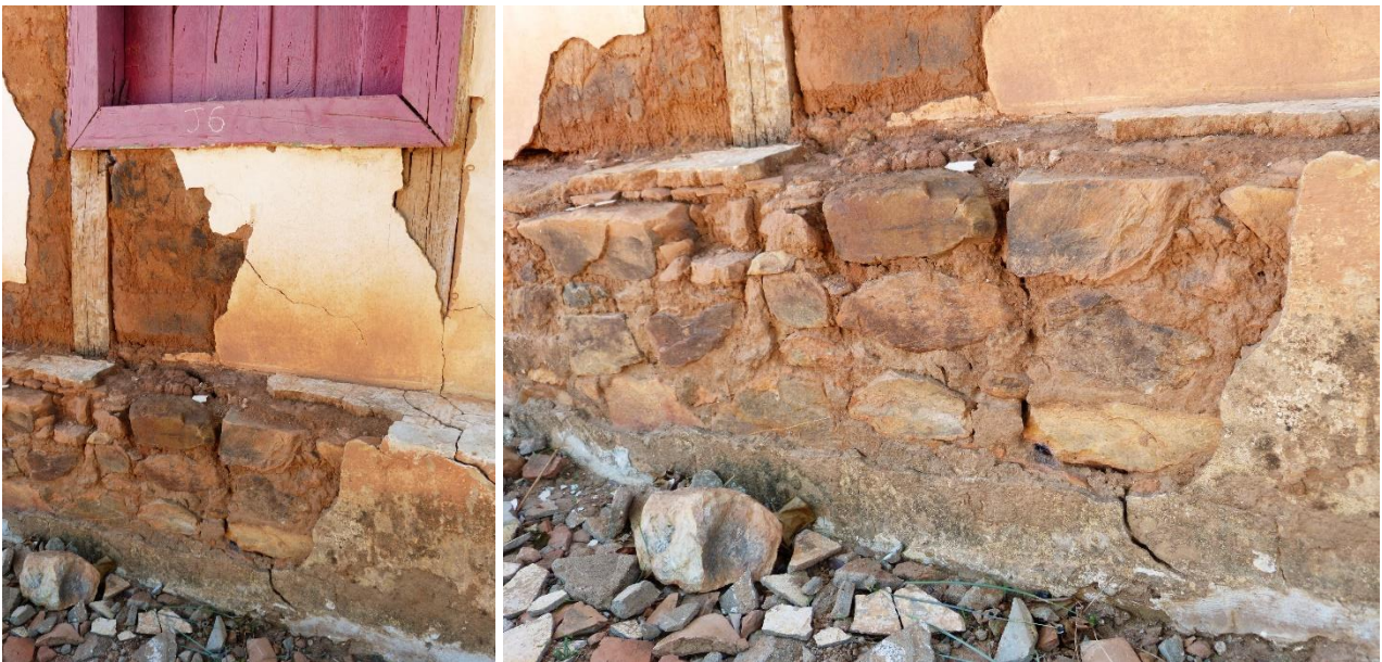
Fig. 36 – Desaprumo / rachaduras no alicerce devido à sobrecarga lateral.
