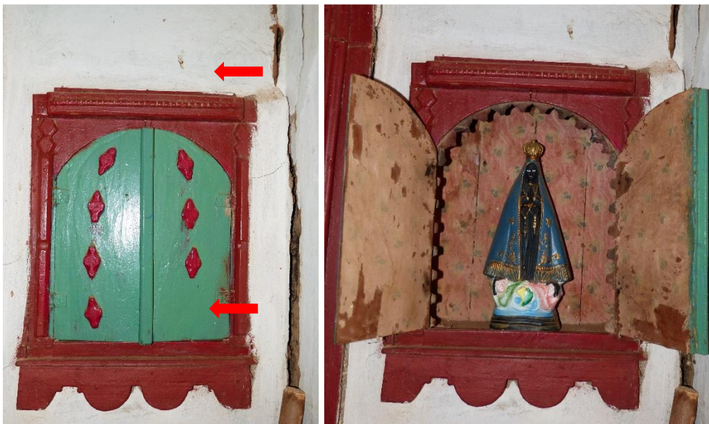
Fig. 160 – Detalhe do Nicho da Capela do Santíssimo (lado direito) – Estado geral de conservação.
