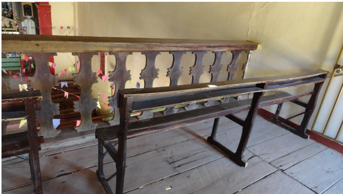
Fig. 107 – Detalhe do estado de conservação – Guarda-corpo do coro.
