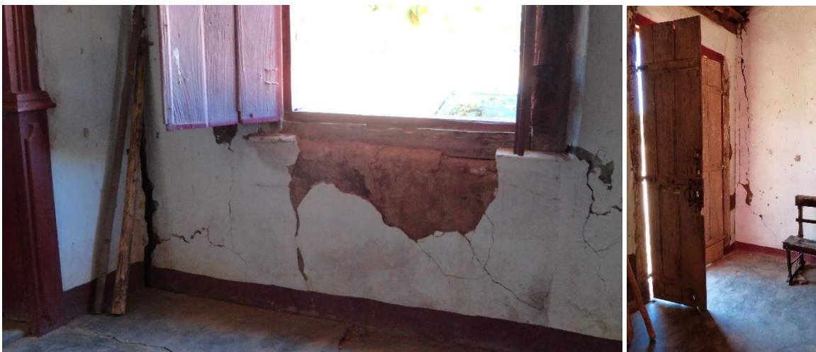
Fig. 47 – Sacristia do Lado Direito – Rachaduras na ligação entre as paredes internas e externas.
