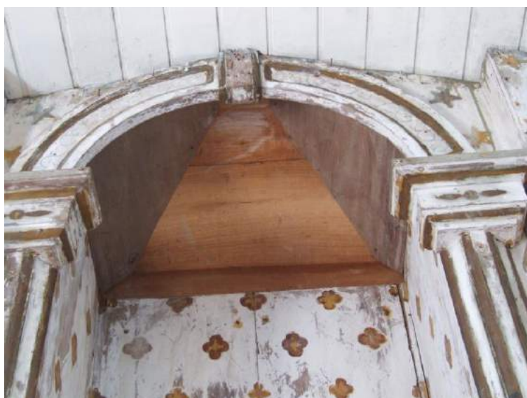
Foto 77 – Retábulo de Nossa Senhora das Dores – Falta de elemento central e substituição do forro do camarim.
