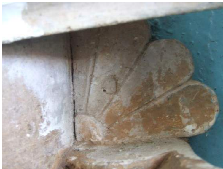
Foto 89 – Lavabo da Sacristia – Aleta lateral inferior refeita em cimento.
