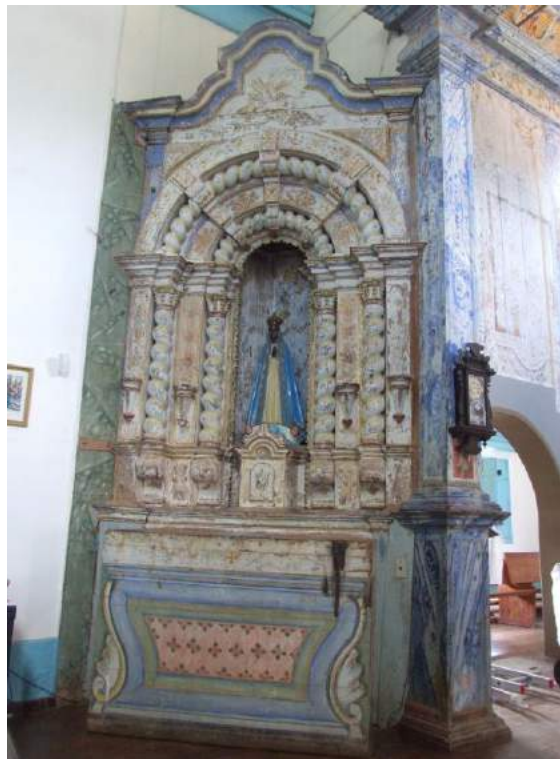
Foto 48 – Retábulo arco cruzeiro lado do evangelho – Perdas de suporte, repintura e perdas de pintura.
