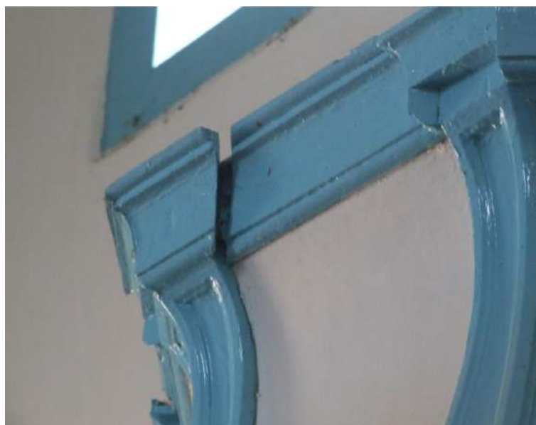
Foto 64 – Púlpito – Deslocamento de junções.
