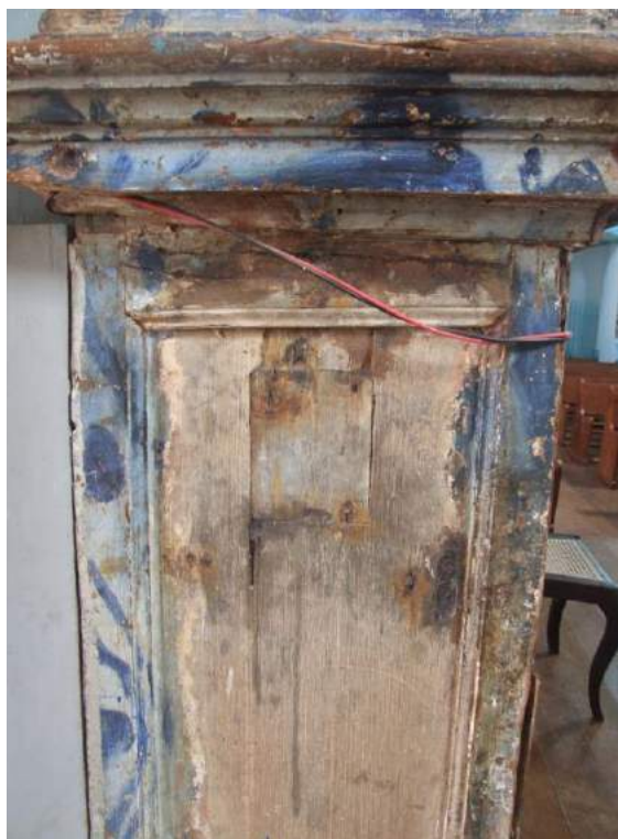
Foto 46 – Arco cruzeiro – Perdas, rachaduras, manchas e complementações com pó de serragem e cola.
