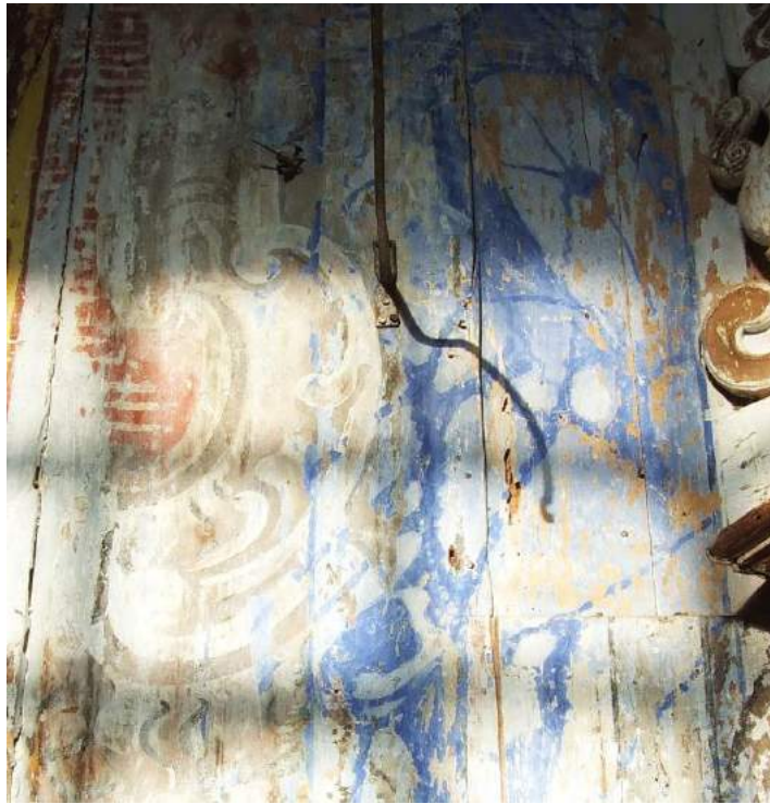
Foto 29 – Pinturas parietais e cimalha – Galerias abertas ocasionadas por ataques de insetos xilófagos.
