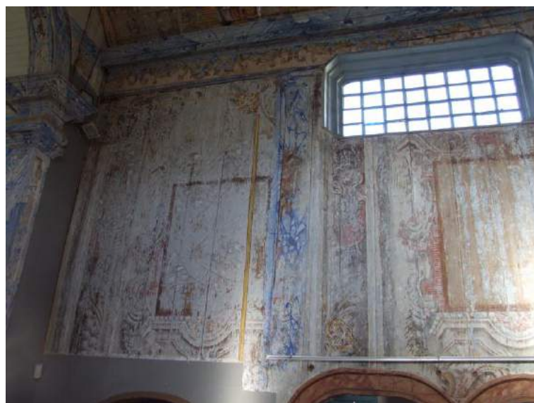
Foto 19 – Pinturas parietais e cimbalha lado do evangelho – Repintura e pintura original abrasionada.
