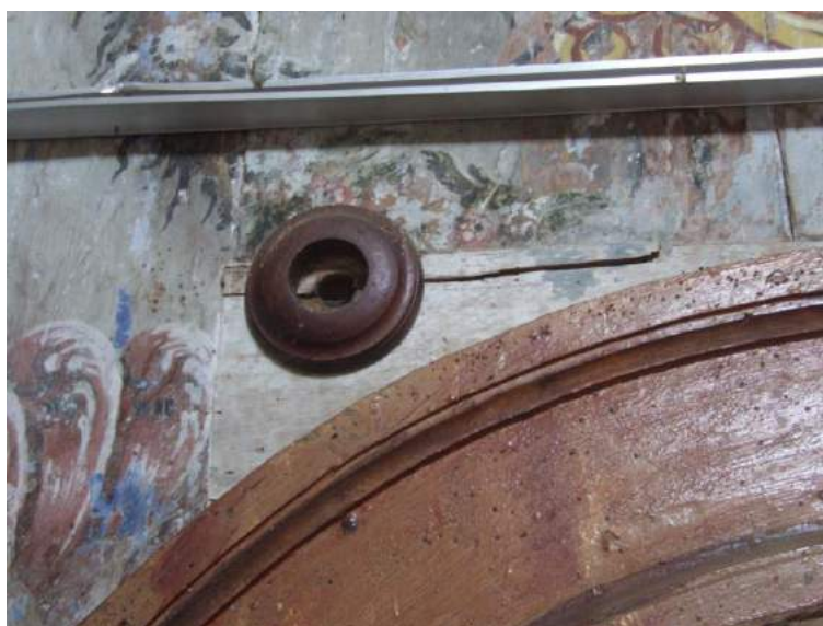
Foto 25 – Pinturas parietais e cimalha – Rachaduras e elemento inserido.
