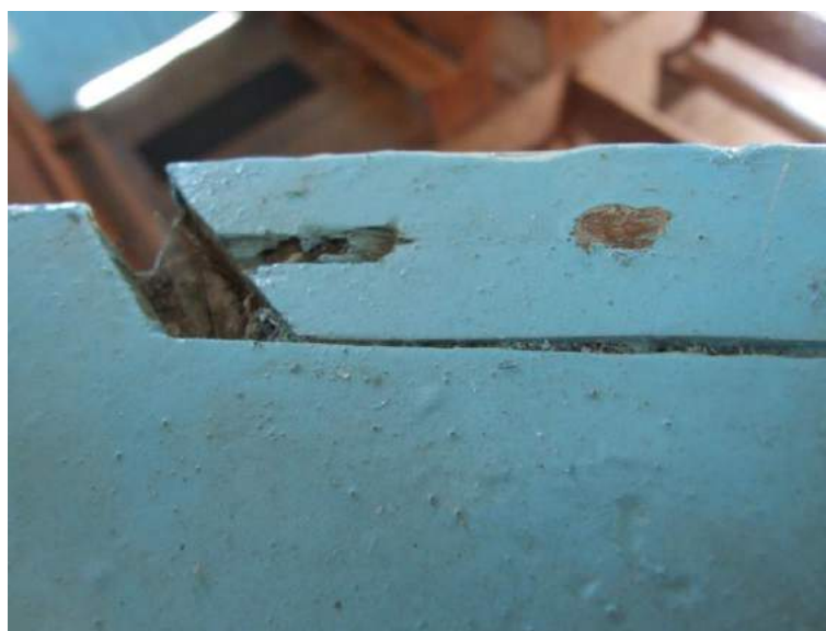
Foto 63 – Púlpito – Perda de suporte e área de prospecção à direita.
