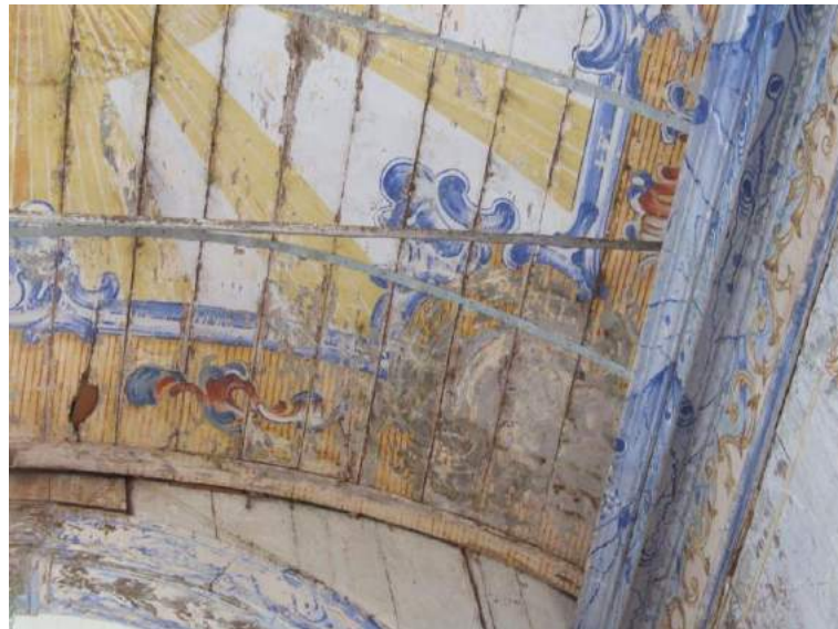
Foto 34 – Forro da capela-mor – Perda de suporte, repintura, pintura antiga, manchas de chuva e perdas de pinturas.
