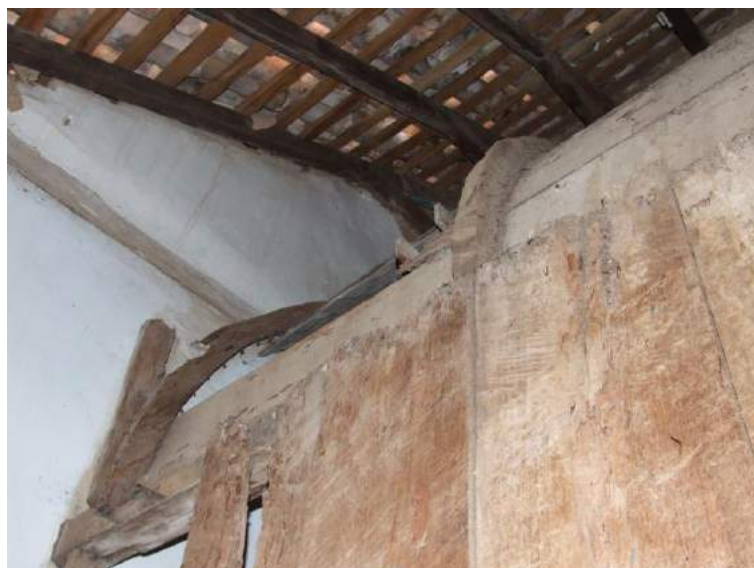
Foto 12 – Retábulo-mor – Cambotas e estrutura do camarim com perdas.
