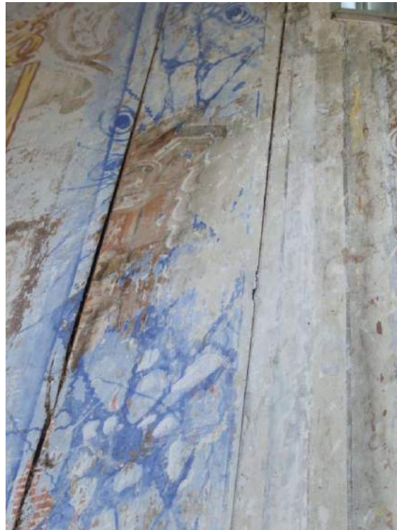
Foto 27 – Pinturas parietais e cimalha – Resquício de repintura azul.
