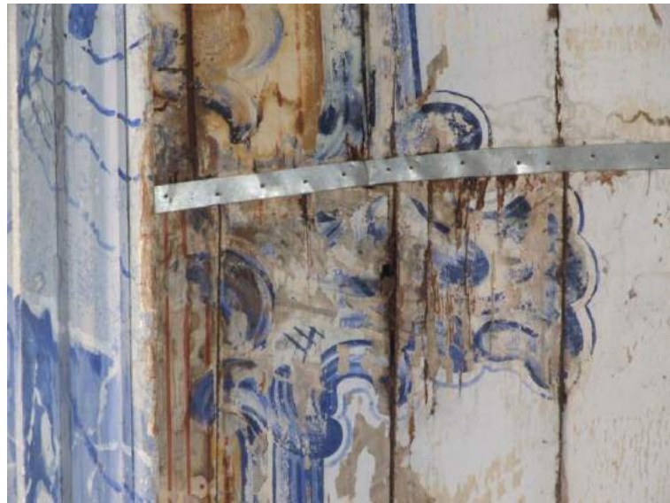
Foto 36 – Forro da capela-mor – Tábuas apodrecidas por penetração de água de chuva.
