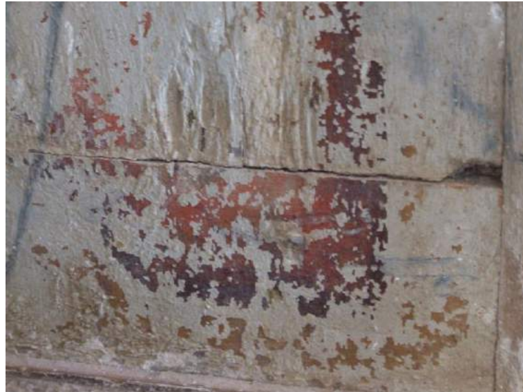
Foto 6 – Retábulo-mor – Deformações e perdas no suporte e pintura subjacente visível.
