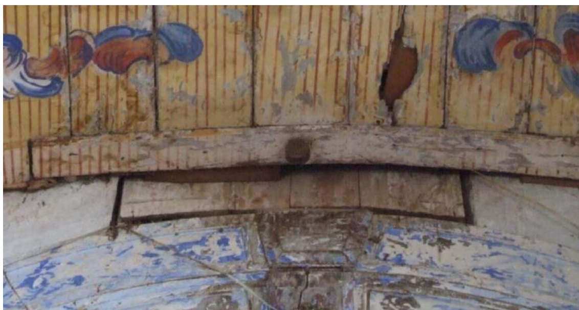
Foto 38 – Forro da capela-mor – Espaçamento entre forro e arco cruzeiro.
