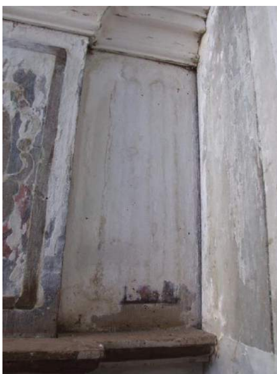
Foto 15 – Retábulo mor – Marcas de penetração de água e manchas.
