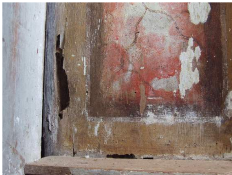
Foto 7 – Retábulo-mor – Galerias de insetos xilófagos e perdas de pintura.
