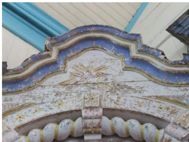
Foto 49 – Retábulo arco cruzeiro lado do evangelho – Perdas de suporte, repintura e perdas de pintura.
