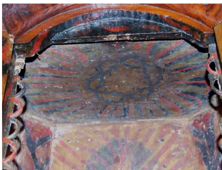
Foto 96 – Oratório da Sacristia – Forro.
