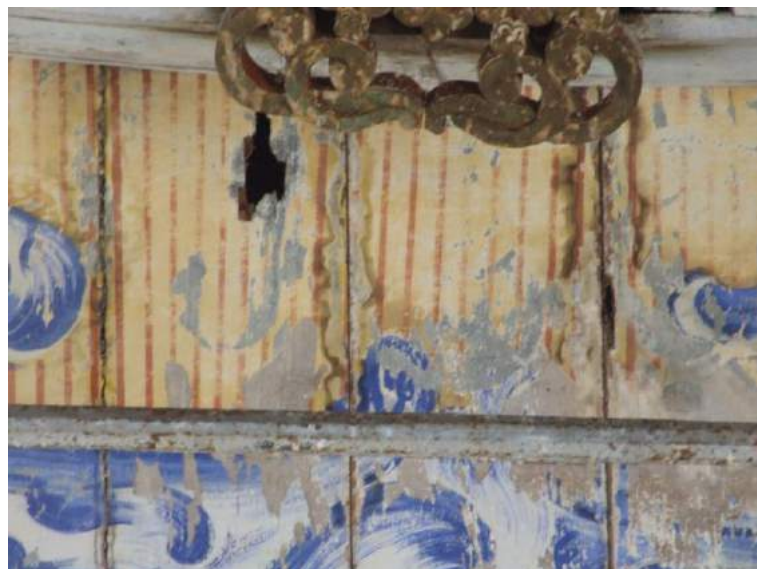
Foto 35 – Forro da capela-mor – Perda de suporte e manchas na pintura.
