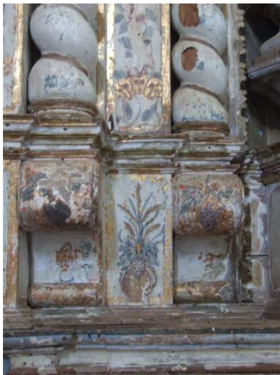
Foto 58 – Retábulo arco cruzeiro lado da epístola – Perda de repintura e de pintura antiga.
