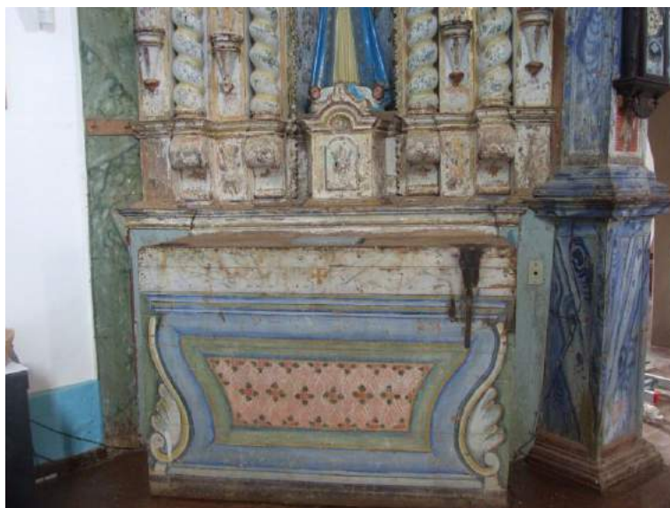
Foto 50 – Retábulo arco cruzeiro lado do evangelho – Mesa com queimado na lateral direita, repintura e perdas de pinturas.
