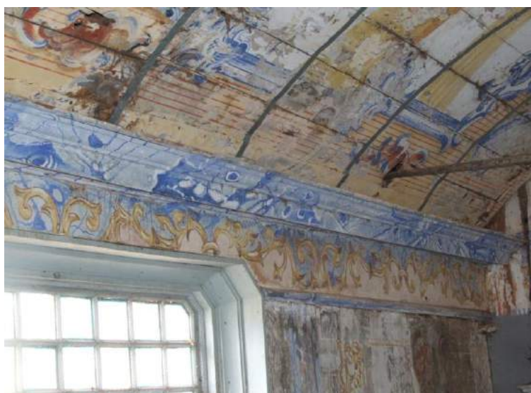
Foto 21 – Pinturas parietais e cimalha – Separação da cimalha no canto.
