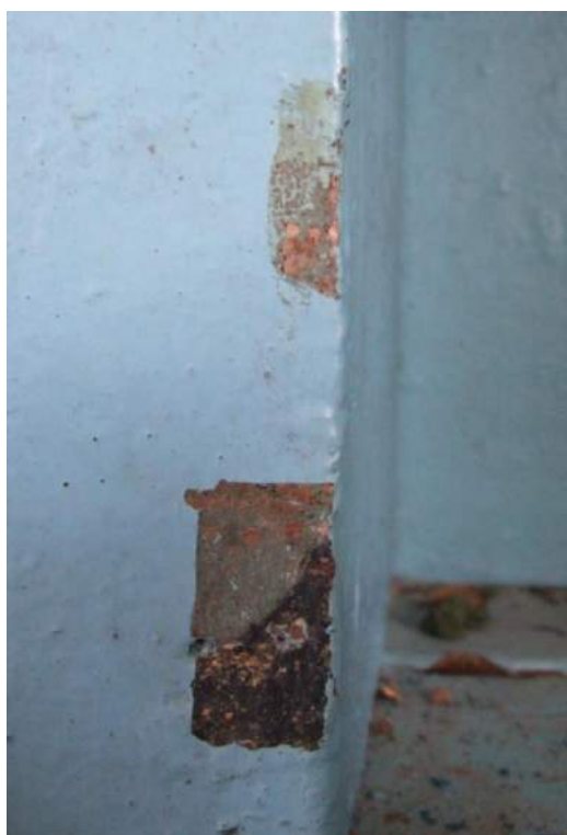
Foto 10 – Retábulo-mor – Prospeções no trono e no revestimento da parede do camarim
