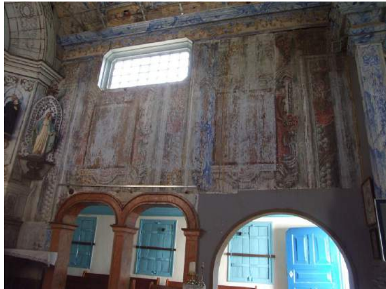
Foto 18 – Pinturas parietais e cimbalha lado da epístola – Repintura e pintura original abrasionada.
