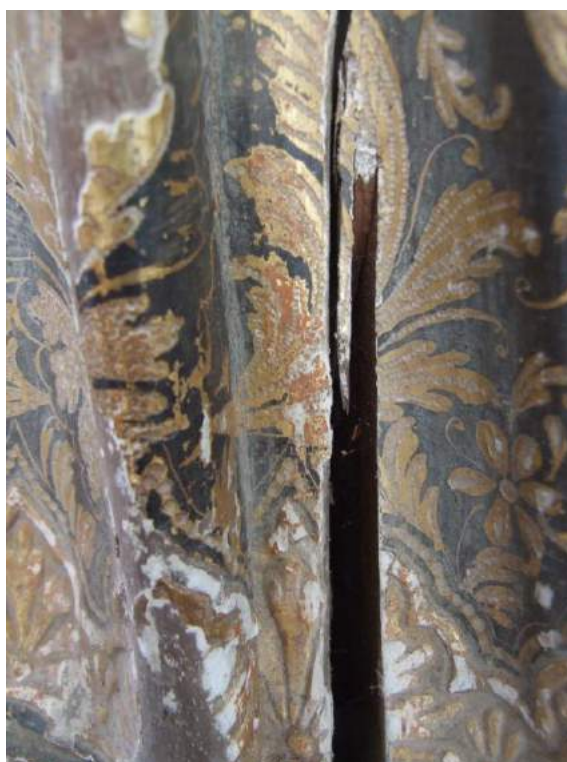
Foto 115 – Santo Antônio de Pádua – Rachadura com perda de suporte.
