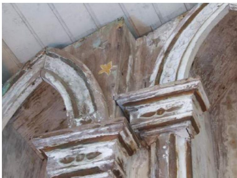
Foto 76 – Retábulo de Nossa Senhora das Dores – Parte superior com perda de pintura e aparente corte para adaptação.
