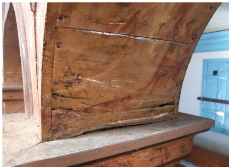
Foto 30 – Pinturas parietais e cimalha – Arco de madeira carcomido por insetos xilófagos.
