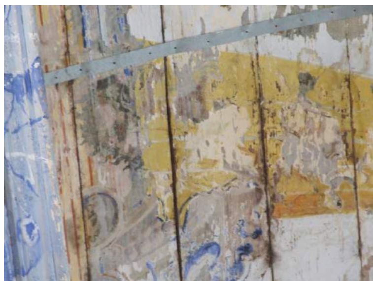
Foto 37– Forro da capela-mor – Fitas de alumínio sustentando suporte em desprendimento, apodrecido e com perdas.
