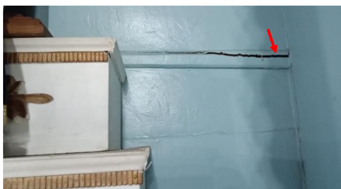
Figura 48: Rachadura em friso do fundo do camarim.
