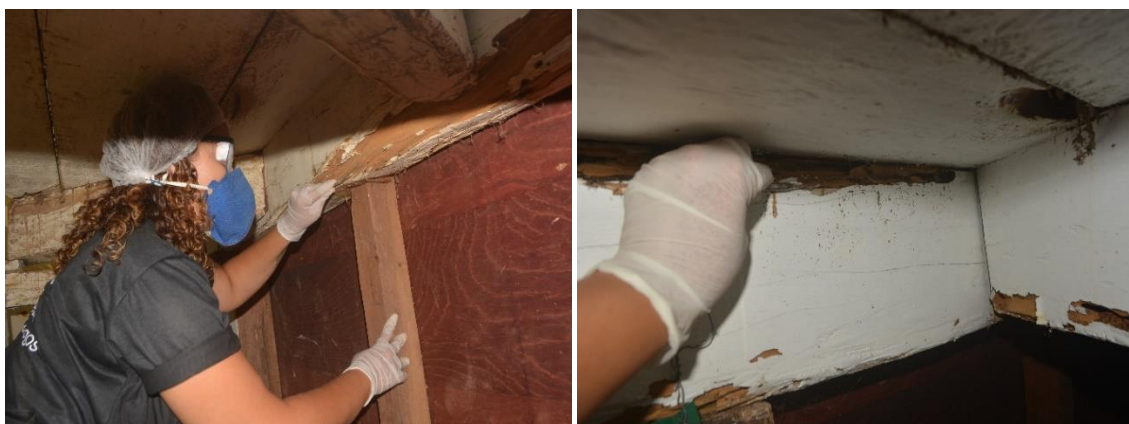
Figuras 54 e 55: Infestação de insetos xilófagos na estrutura do retábulo.
